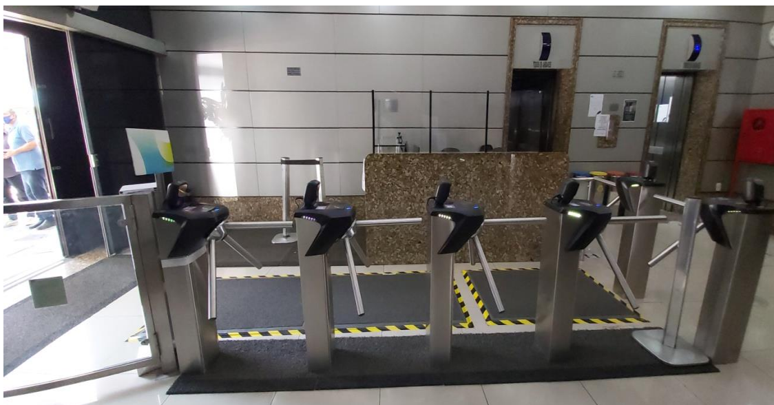
Figura 47- Roletas do andar térreo que não destravam em caso de incêndio
