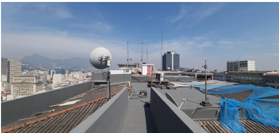
Figura 56 - acesso pelo cobertura na área dos chillers com demarcações de direcionamento para o prédio vizinho
