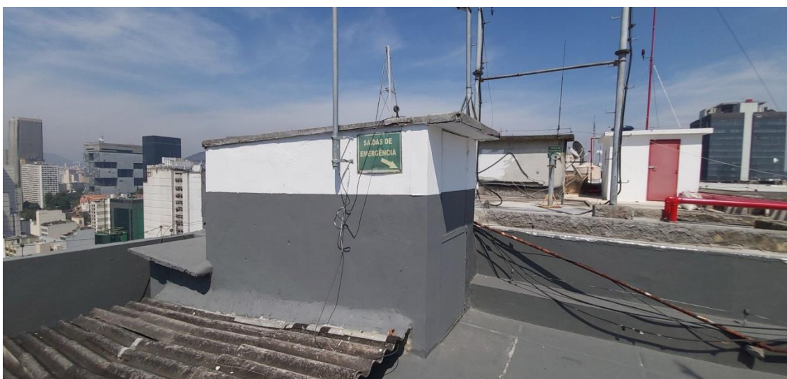
Figura 57- acesso pelo cobertura na área dos chillers com demarcações de direcionamento para o prédio vizinho
