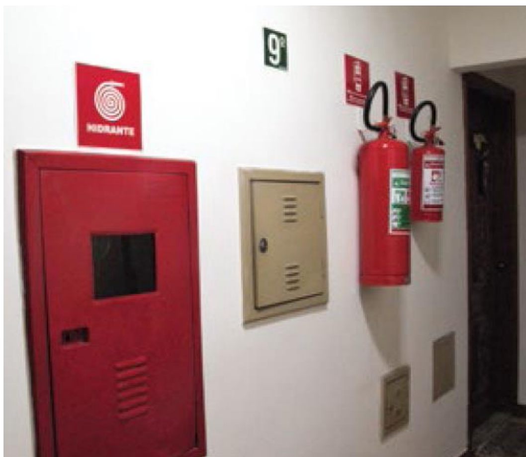
Figura 36- Detalhe dos itens de combate a incêndio distribuídos nos pavimentos
