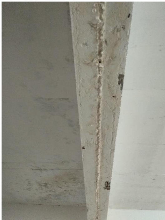
Figura 39 Infiltrações, estalactites e sinais de corrosão das armaduras na viga próxima às garagens 404 B e 901 A.
