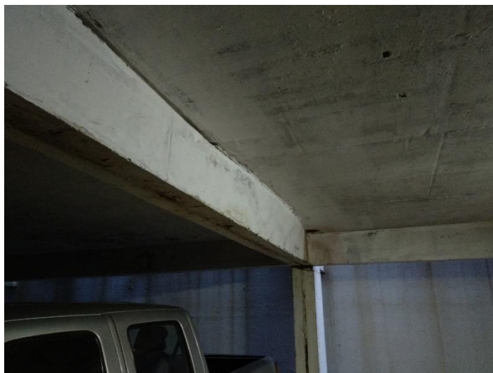
Figura 37 Desplacamento do concreto e sinais de corrosão da armadura na viga alinhada na direção dos pilares 302 C e 903 B
