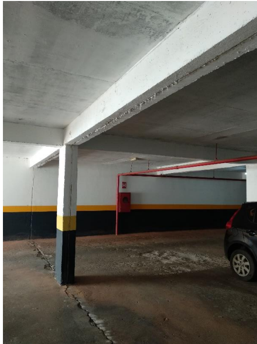
Figura 38 Infiltrações, estalactites e sinais de corrosão das armaduras na viga próxima às garagens 404 B e 901 A.
