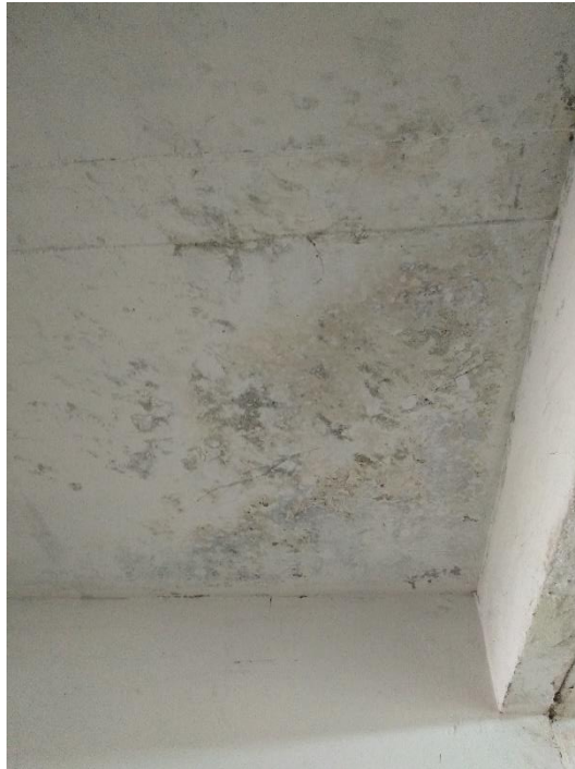
Figura 44 Sinais de infiltração na laje de cobertura do 1º subsolo
