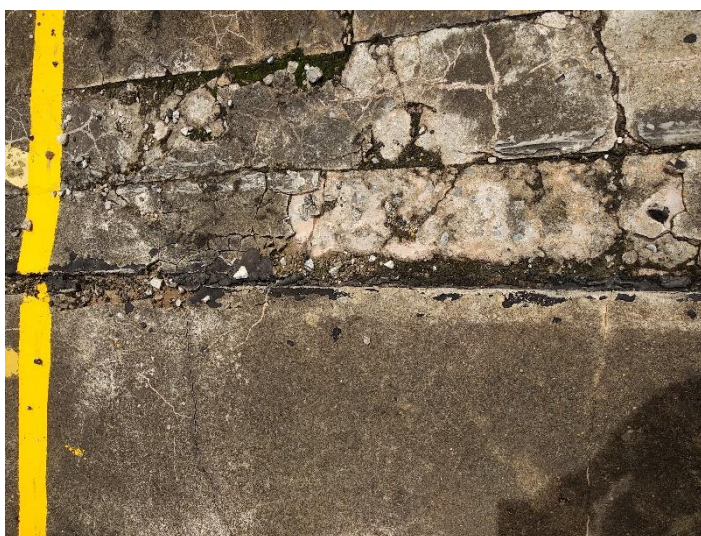
Figura 56 Danos apresentados na 2ª junta de dilatação da garagem descoberta, coincidente com a junta do alinhamento 604 A e 401 A
