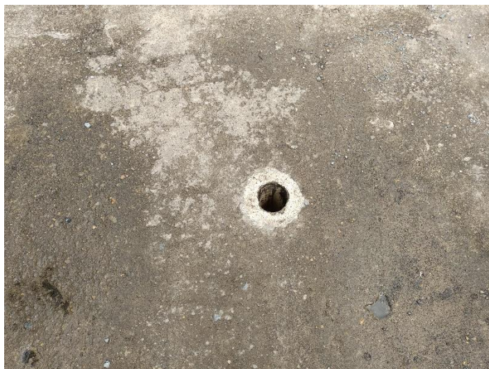
Figura 54 Orifício no piso de concreto da garagem descoberta
