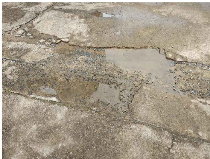
Figura 55 Danos apresentados na 1ª junta de dilatação da garagem descoberta, coincidente com a junta do alinhamento 404B e 901 A
