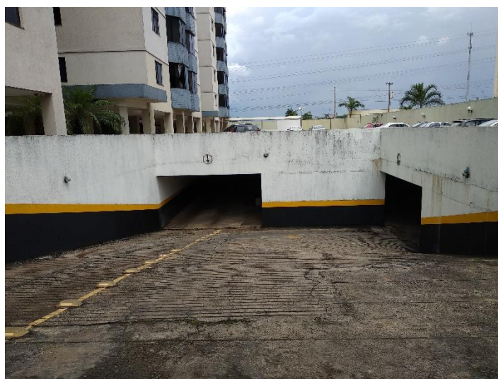
Figura 53 Fissuras/trincas e deslocamento do piso de concreto da garagem descoberta
