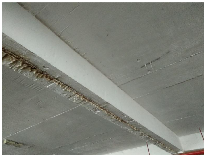
Figura 40 Estalactites na viga próxima às garagens 604 A e 401 A.
