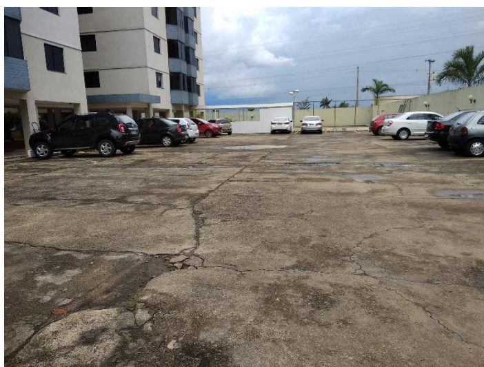
Figura 52 Fissuras/trincas no piso de concreto da garagem descoberta
