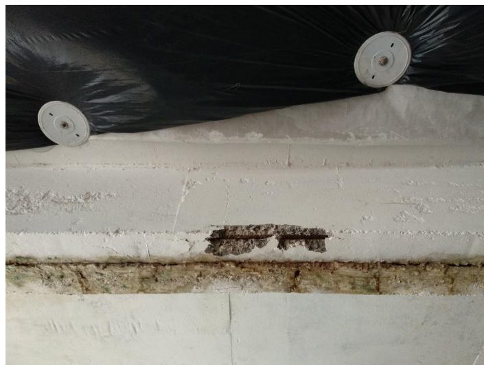
Figura 42 Deslocamento do concreto, corrosão do aço e sinais de infiltração na viga próxima às garagens 604 A e 401 A.
