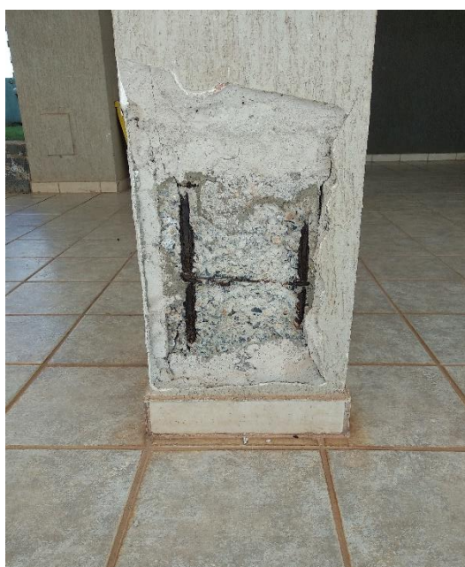
Figura 48 Corrosão das armaduras dos pilares ensaiados
