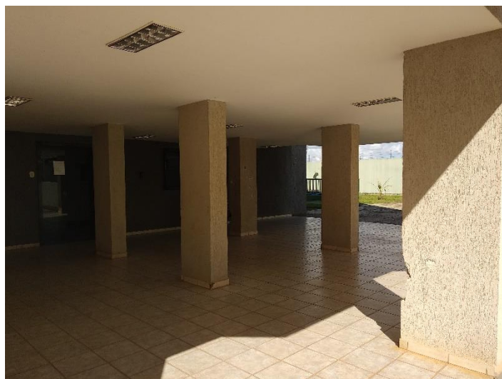
Figura 47 Pilares, voltados para a garagem descoberta, que apresentam fissuras/ trincas no revestimento argamassado.
