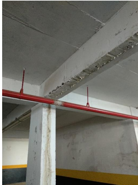
Figura 41 Sinais de infiltração na viga próxima às garagens 604 A e 401 A.
