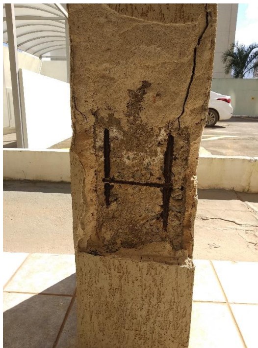
Figura 49 Corrosão das armaduras dos pilares ensaiados
