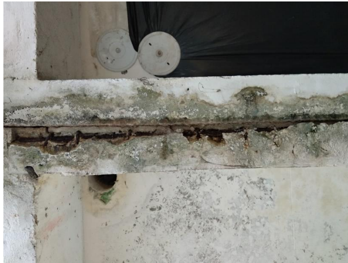
Figura 43 Deslocamento do concreto, corrosão do aço e sinais de infiltração na viga próxima às garagens 604 A e 401 A.
