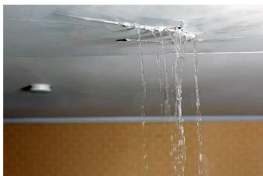
Figura 6 – Laje com infiltração (Macre Engenharia, 2022)
