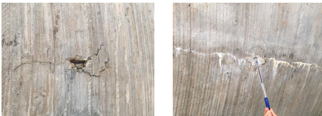
Figura 24 – Deslocamento, eflorescência, possível corrosão (autoria própria, 2025).
