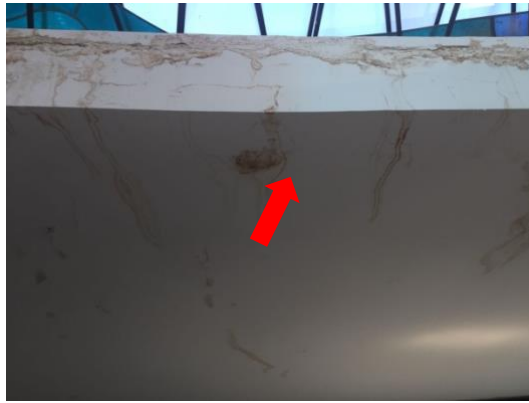
Mancha de infiltração e fissuras
