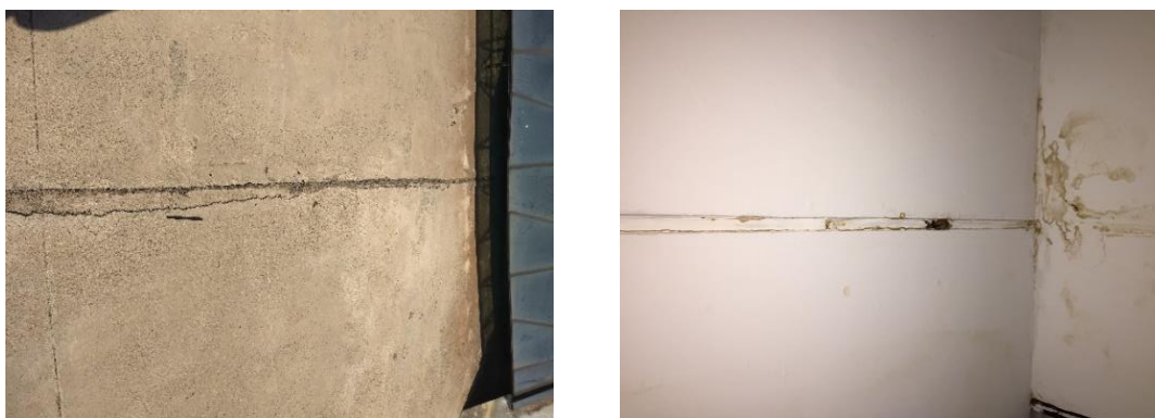
Figura 23 – Juntas de dilatação externa do Espelho d'água e interna, do corredor para o batistério Piso fissurado, pintura manchada, falha de selante da junta (Autoria própria, 2025)
