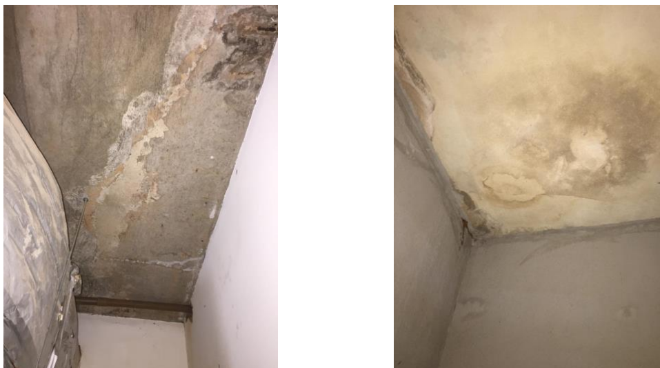
Figura 20 – Manchas, fissuras, armadura exposta e corrosão na laje da sala de máquinas – Laje 01 do APÊNDICE I (autoria própria, 2025)
