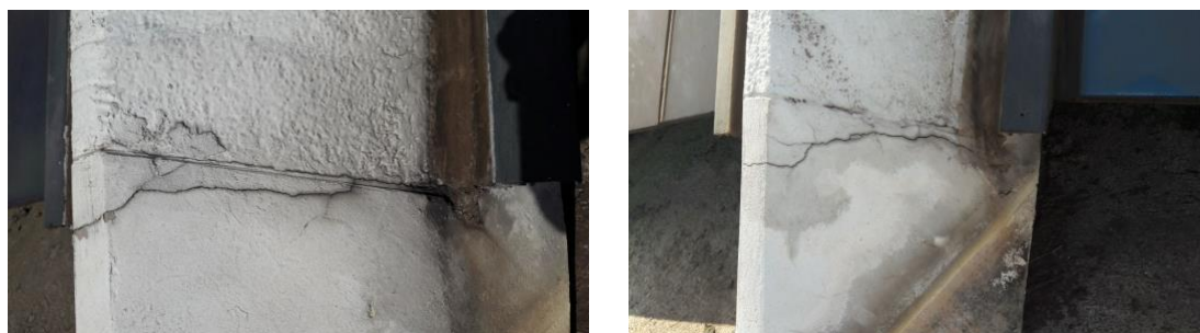
Figura 18 – Pilares 7 e 13 do Apêndice I - Fissuras, umidade ascendente (Autoria própria)
