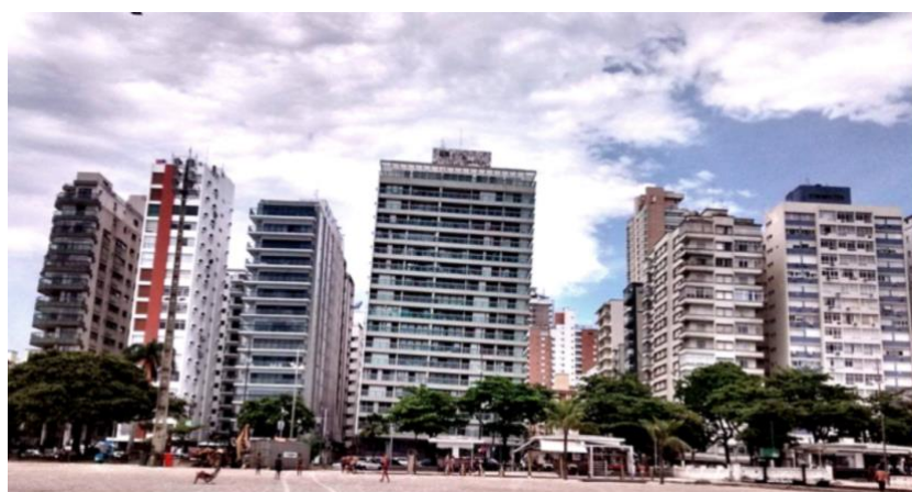
Figura 8 - Prédios em desnível devido ao recalque (unicamp.br, 2021)
