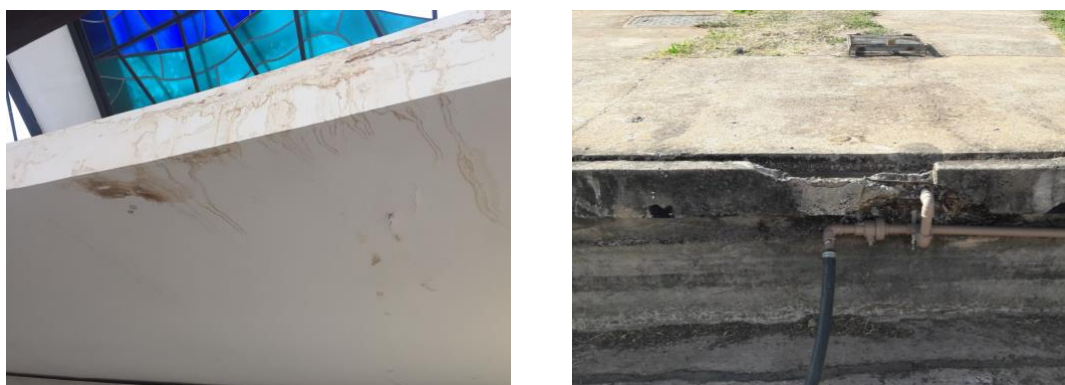
Figura 21 – Lajes 03 e 04 do APÊNDICE I - Manchas, infiltração, desagregação e fissuras (Autoria própria, 2025)
