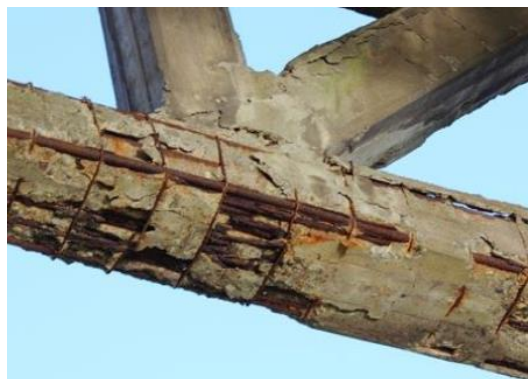
Figura 2 - Corrosão das armaduras - (TERSARIOL, 2017).
