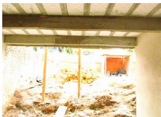
Figura 3 - Vigas com desvio geométrico (FERRAZ, 2003).
