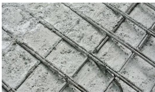
Figura 5 - Falha de concretagem (AECweb, 2021)
