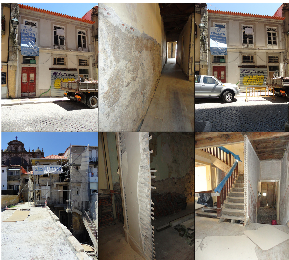
Fig. 12. Fachada principal do edifício com exemplo da parede de meação com o edifício vizinho à esquerda da porta de entrada. Fig. 13. A mesma parede de meação vista de dentro, com revestimento retirado até à alvenaria de pedra. Fig. 14. Fachada principal. Fig. 15. Fachada Posterior. Fig. 16. Parede interior de tabique simples. Fig. 17. Parede interior de escada de tabique simples.
