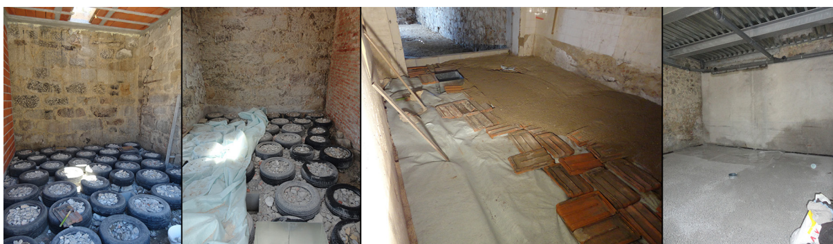
Fig. 21. Pneus aplicados com o cascalho no seu interior. Fig. 22. Manta geotêxtil a cobrir os pneus. Fig. 23. Telhas a fazer a caixa-de-ar e terra a cobrir. Fig. 24. Pneus enchidos a betonilha pronto a ser aplicado o pavimento final.
