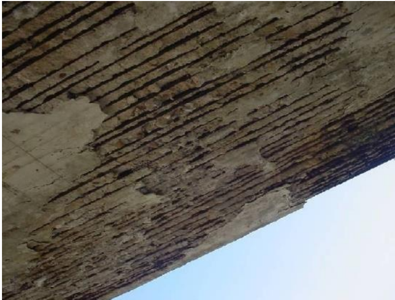
Figura 14: Vista inferior da laje do tabuleiro, mostrando deslocamento do betão e corrosão da armadura [16].
