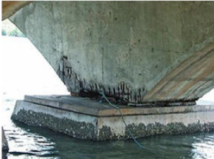
Figura 3: Ponte afetada por ataque de sulfato [20].
