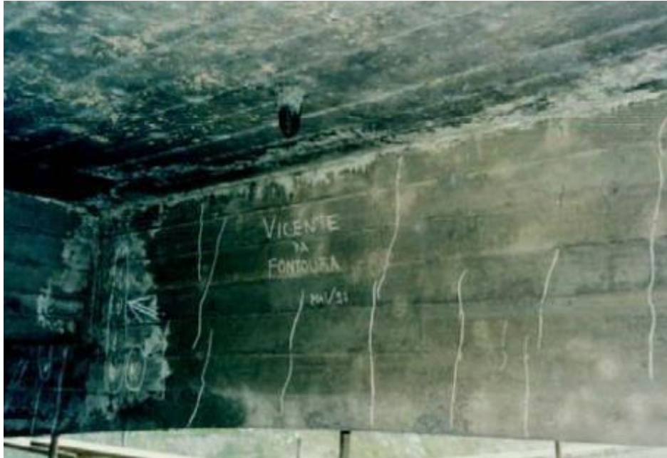
Figura 20: Fissuração por retração hidráulica/térmica na Ponte Vicente da Fontoura [47].
