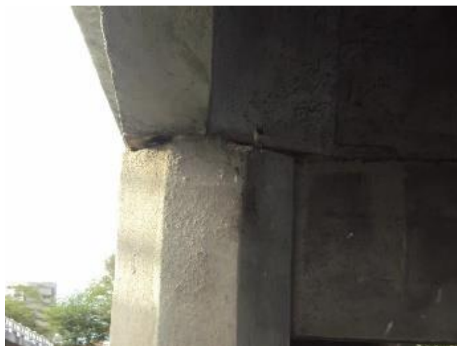
Figura 34: Fissuras na parte que faz a ligação da viga longarina com pilar na ponte Juscelino Kubitschek.
