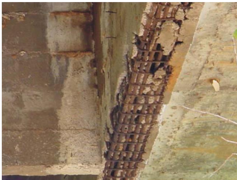
Figura 15: Viga principal em betão deslocado e corrosão de armaduras, da Ponte sobre o rio Várzea I, em Piauí [25].
