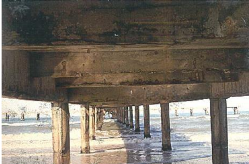
Figura 8: Corrosão de armaduras em pontes em zona de variação de maré [33].
