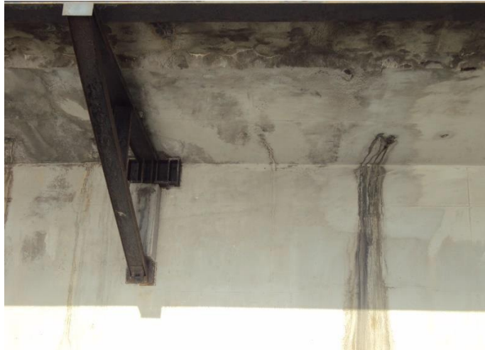
Figura 39: Oxidação no suporte da laje em balanço, mancha de umidade pelo dreno, fissuras com início de corrosão.
