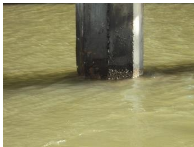
Figura 37: Pontos de corrosão e segregação de betão nas arestas do pilar da Ponte Juscelino Kubitschek.
