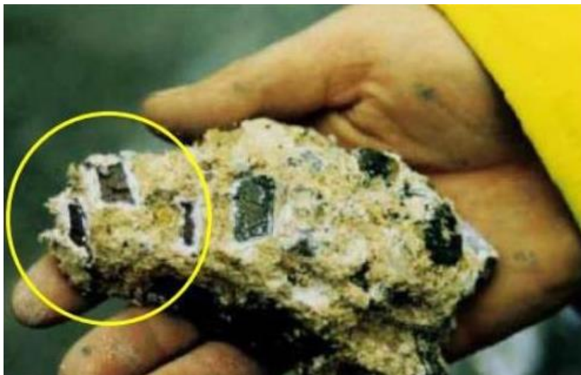
Figura 2: Pedação de betão de fundação de ponte deteriorado por íons de sulfato [19].
