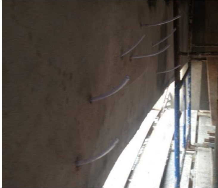
Figura 30: Reparos para fissuras com tubos plásticos num das longarinas da ponte Paulo Barreto Menezes [50].
