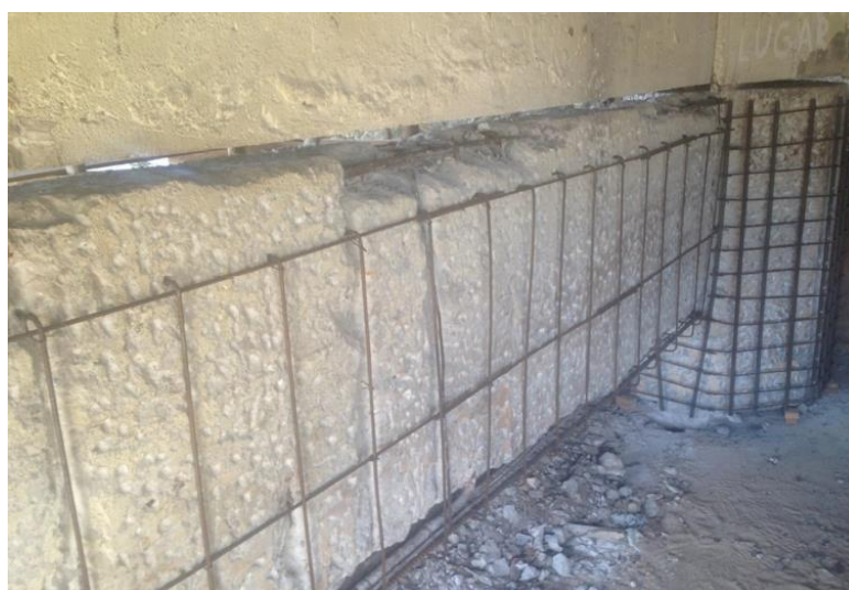
Figura 26: Superposição de armaduras no encontro da ponte Juscelino Kubitschek [50].
