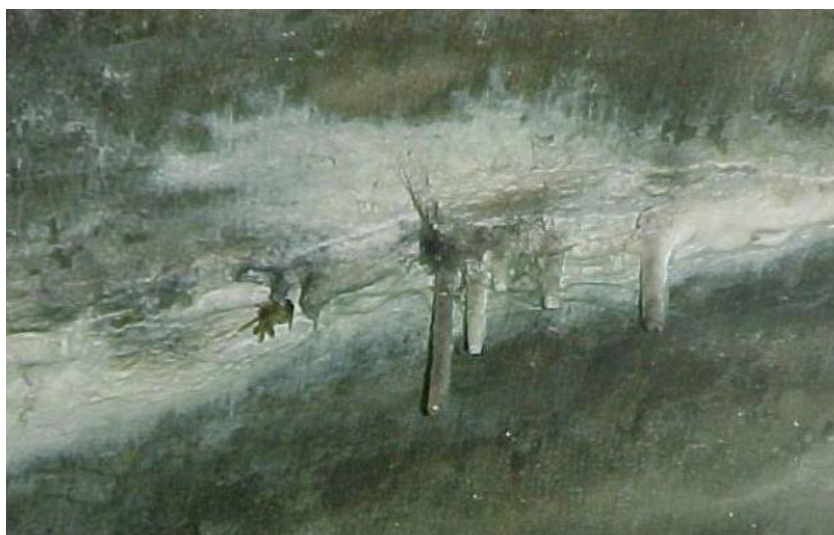
Figura 10: Presença de eflorescência [25].
