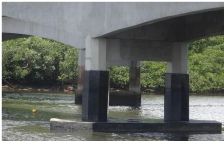
Figura 29: Pilares e blocos de coroamento pintados com alcatrão, das Pontes Juscelino Kubitschek e Paulo Barreto Menezes [50].
