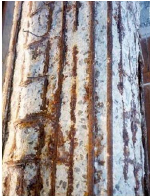
Figura 9: Pilar sobre o mar após 10 anos de construção, deteriorado devido aos efeitos de carbonatação com íons de cloretos [34].
