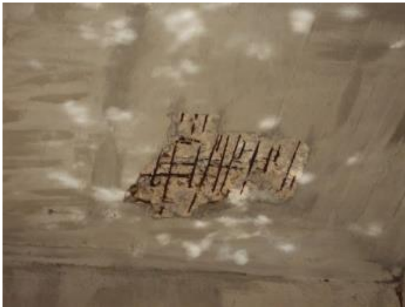
Figura 31: Corrosão com armaduras expostas, eflorescência e deslocamento de betão, na face inferior do tabuleiro da ponte Juscelino Kubitschek.
