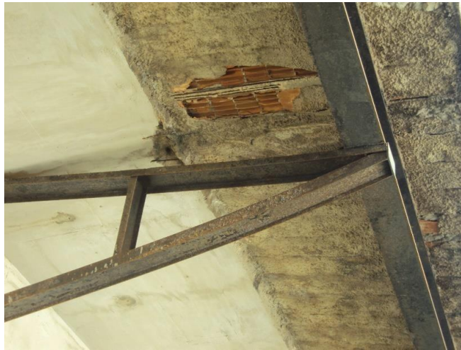
Figura 40: Desplacamento da alvenaria, corrosão na armadura e oxidação no suporte da laje inferior da ciclovia.
