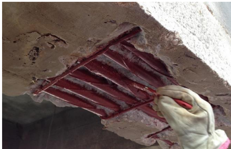
Figura 28: Tratamento das armaduras por proteção galvânica na viga longarina da ponte Juscelino Kubitschek [50].
