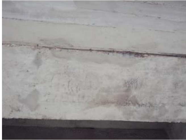
Figura 32: Falha na execução nos reparos da viga longarina e deslocamento de betão na Ponte Juscelino Kubitschek.
