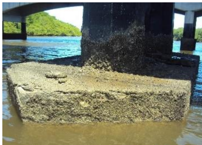
Figura 36: Deslocamento e rachaduras no bloco de coroamento da Ponte Juscelino Kubitschek.
