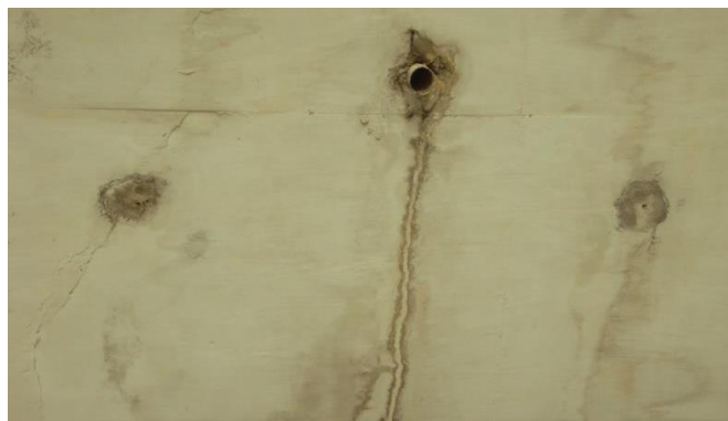
Figura 38: Manchas de umidade na laje inferior da extremidade da ponte, por falha na drenagem pluvial no dreno.
