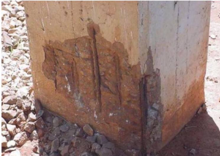
Figura 4: Pilar de uma ponte intensamente degradado por corrosão [25].
