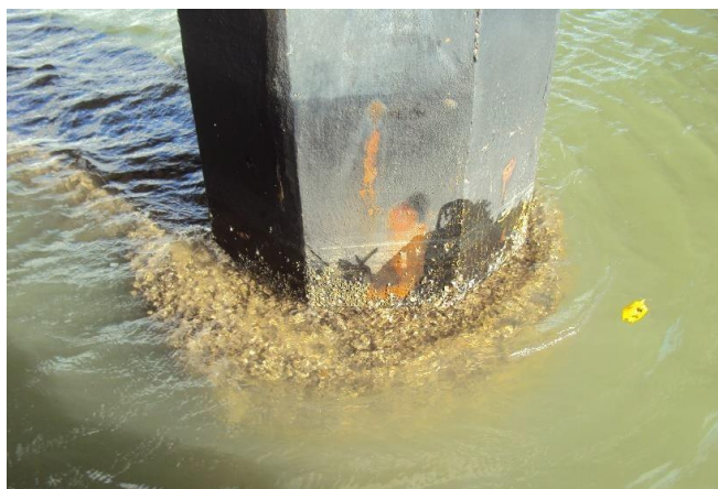
Figura 41: Corrosão e fissuras nos pilares da infraestrutura.
