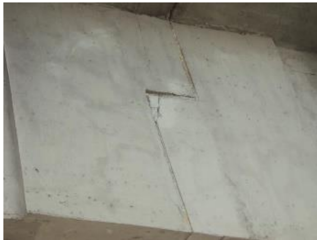
Figura 33: Fissuras no encontro do dente Gerber da Ponte Juscelino Kubitschek.
