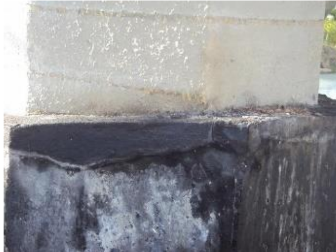
Figura 35: Fissura horizontal e mancha de eflorescência no pilar da mesoestrutura da ponte Juscelino Kubitschek.
