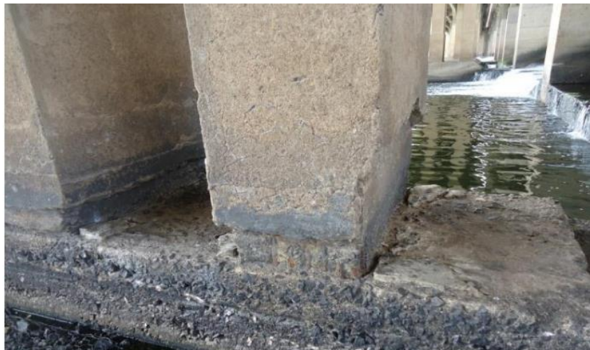
Figura 17: Erosão acentuada na fundação e no pilar da ponte da cidade de Sobral-Ceará [41].
