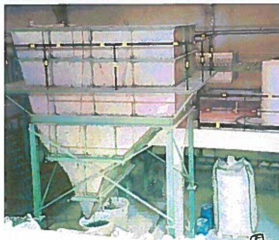
Figura IV.9. – Decantador e filtro-prensa utilizados na Alumínios Ibérica, Lda. como equipamento integrante da ETAR.
