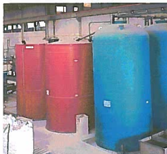
Figura IV.8. – Tanques de concentrados da Alumínios Ibérica, Lda. para o armazenamento das soluções de tratamento.
