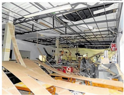
PREJUÍZOS. A explosão dos caixas eletrônicos deixou rastro de destruição no posto de combustíveis
