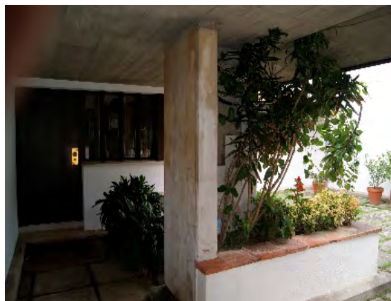
Figura 23. A Casa de Gaia: marcas da madeira no betão descofrado.
