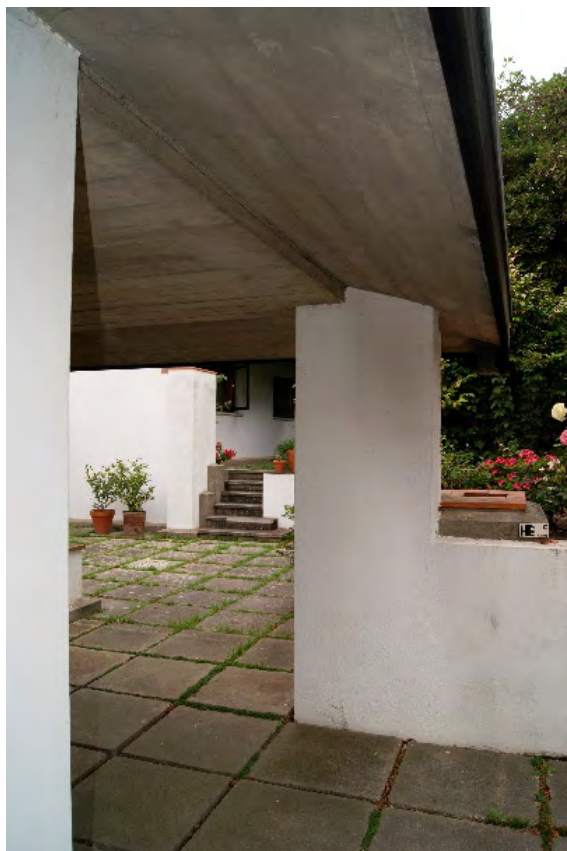
Figura 18. A cobertura em betão sob o telhado. Fonte: fotografia de Ana Rita Moreira.
