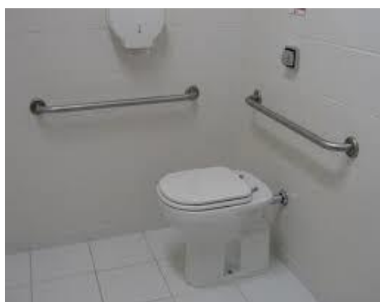
Figura 13. Adaptações para utilização de área em comum (banheiro adaptado)
