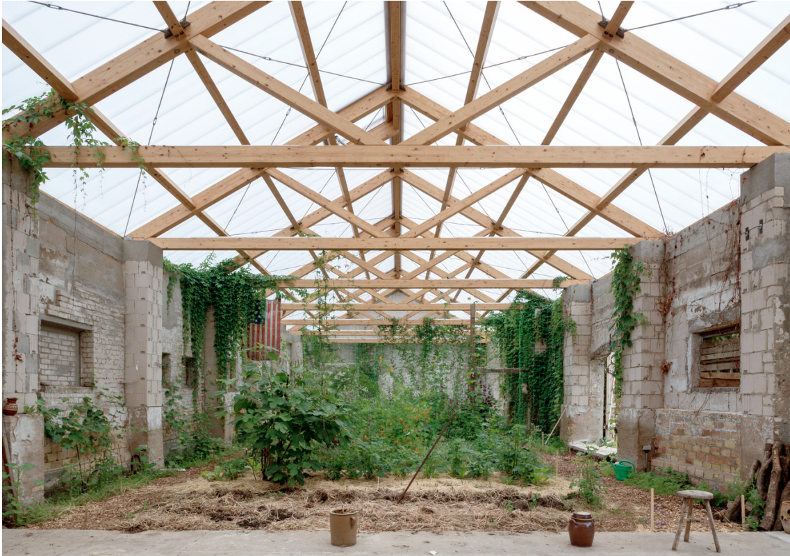
Figura 03 - Criação de uma nova cobertura (união entre o novo e o existente)
