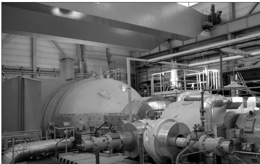
Figura 6 - Turbinas a vapor da Central da Tapada do Outeiro.
