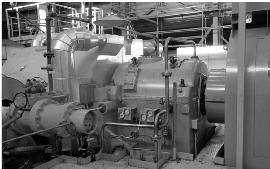
Figura 7 – Embraiagem de acoplamento das turbinas a vapor à turbina a gás da Central da Tapada do Outeiro.
