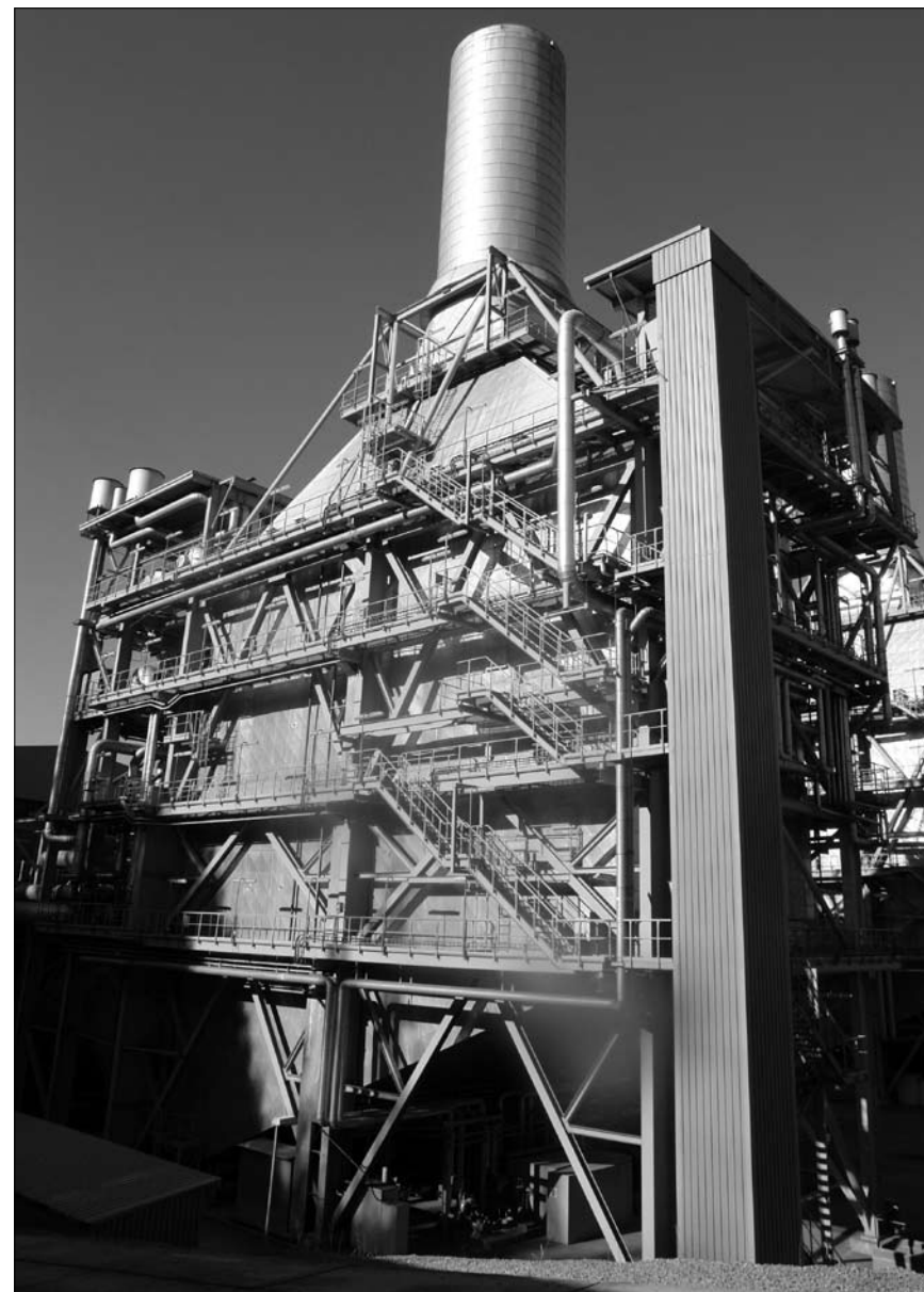
Figura 5 - Caldeira de recuperação de calor da Central da Tapada do Outeiro.
