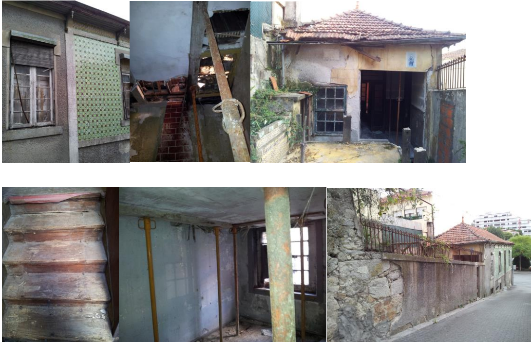
Figura 51 - Fotos da moradia com evidentes sinais de degradação
