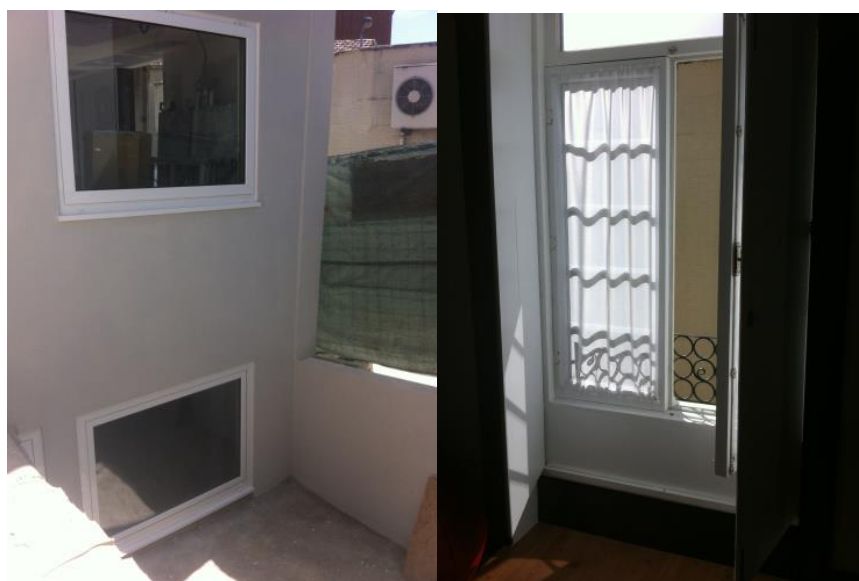
Figura 60 - Caixilhos de alumínio na fachada do anexo e caixilho de madeira no edifício
