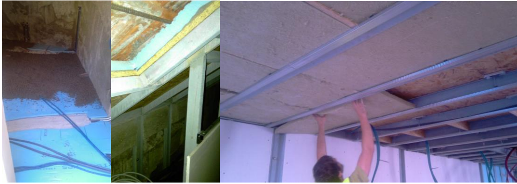
Figura 55 - Isolamento do pavimento da cave, isolamento da cobertura e aplicação de placas de lã de rocha na laje de piso
