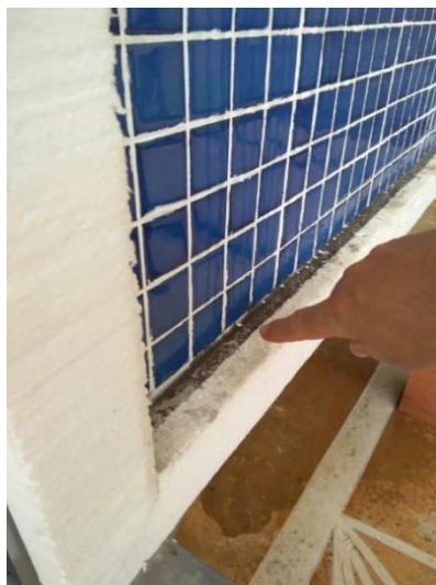
Figura 53 – Calha de acumulação de água. Fonte: o autor.
