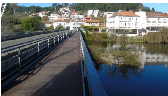
Figura 41 – Passeio acrescentado à antiga ponte. Fonte: Fotografias do autor, 2016.
