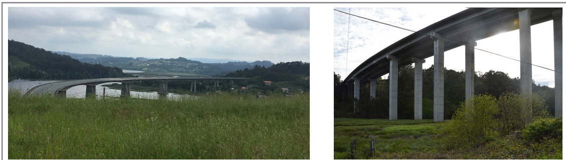
Figura 2.9 Puentes de la AP-9 sobre las marismas del Mandeo y del Lambre, respectivamente. Fuente: Fotografía del Autor.
