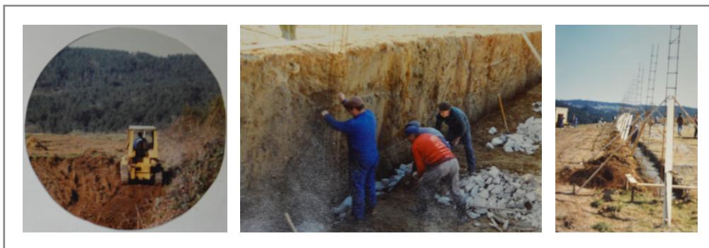
Figura 3.21 Fotografías del proceso de autoconstrucción de cementerio ejecutado por los vecinos. Fuente: AV San Pantaleón.
