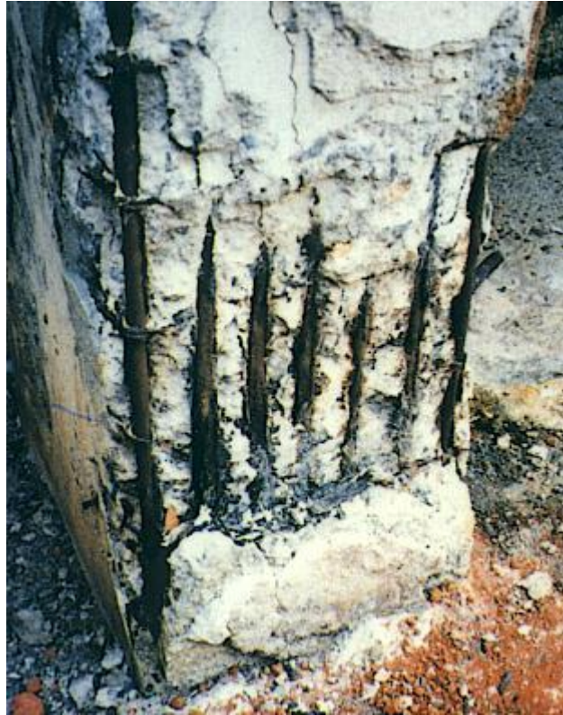
Figura 3 – Pilar apresentando desagregação na sua base com fácil remoção de concreto e presença de corrosão acentuada - fonte: http://patologiaestrutura.vilabol.uol.com.br/relatos.htm
