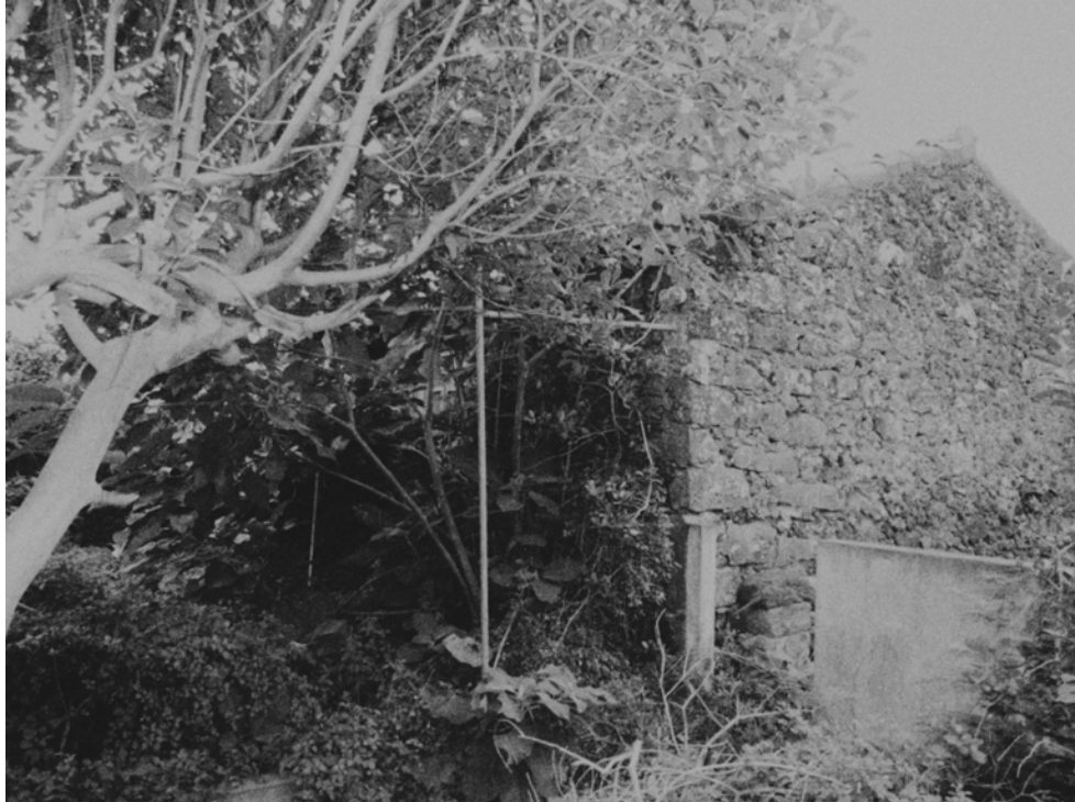
Figura 68 Ruína antes da intervenção
