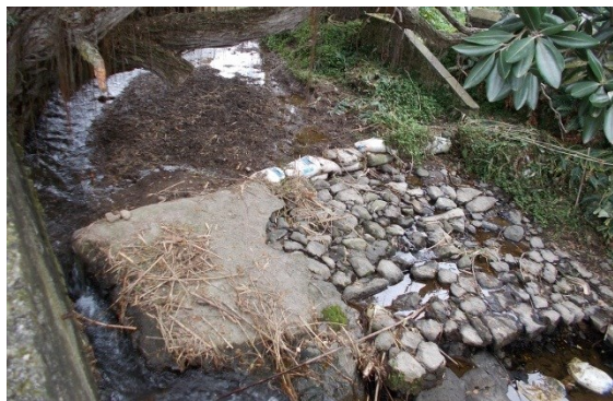
Figuras 11 - Açude que conduz a água diretamente para a embocadura da levada (Fonte: do autor)
