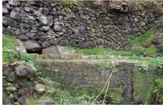
Figura 13 - Captação direta da água da nascente (Fonte: do autor)
