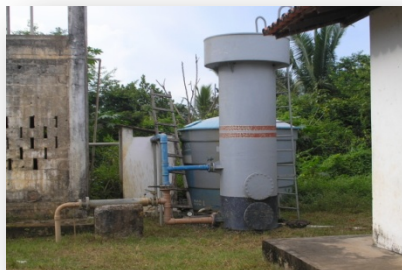
Foto 20 – Estação de Tratamento de Água Fonte: Arquivo Fotográfico Magnificat
