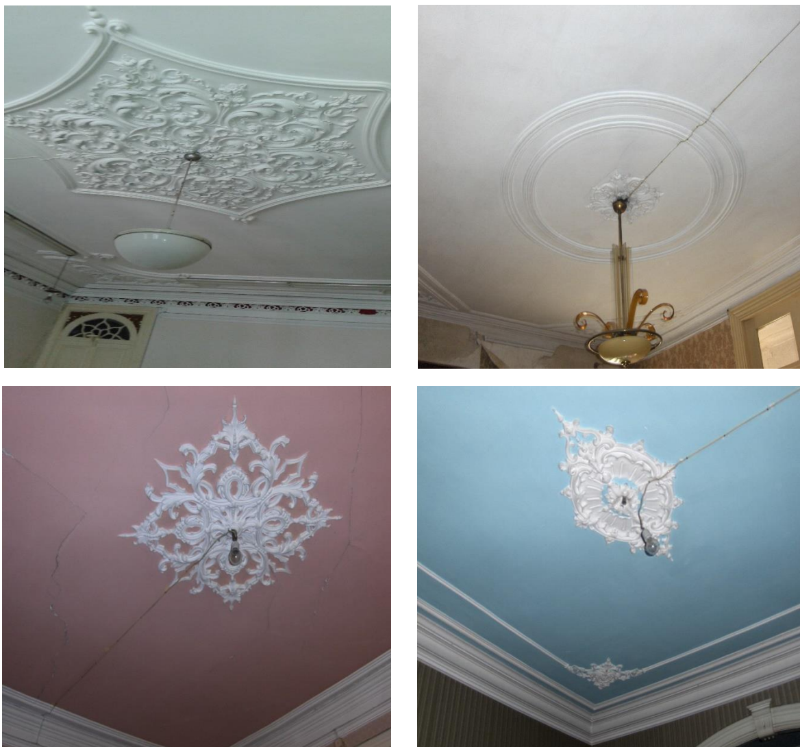
Figura 18 - Tetos estucados (Fonte: AC Maias, Engenharia Lda.)
