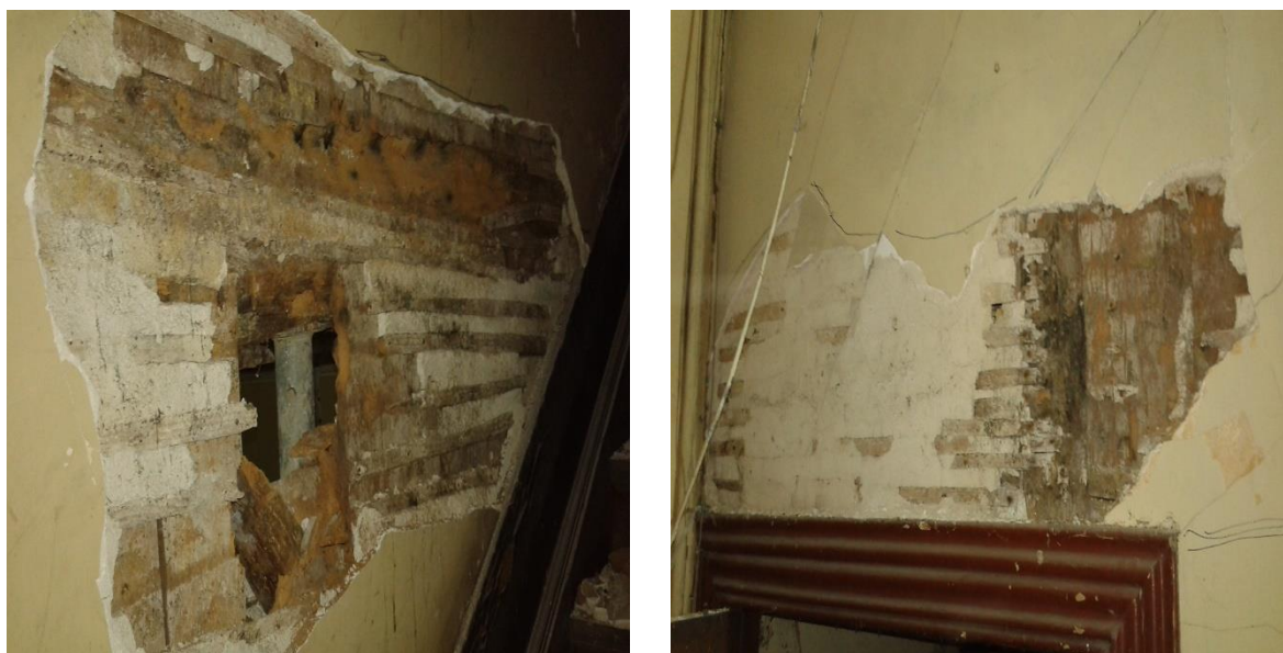
Figura 79 - Paredes de tabique de caixa de escadas (Fonte: AC Maias Engenharia Lda., 2015)
