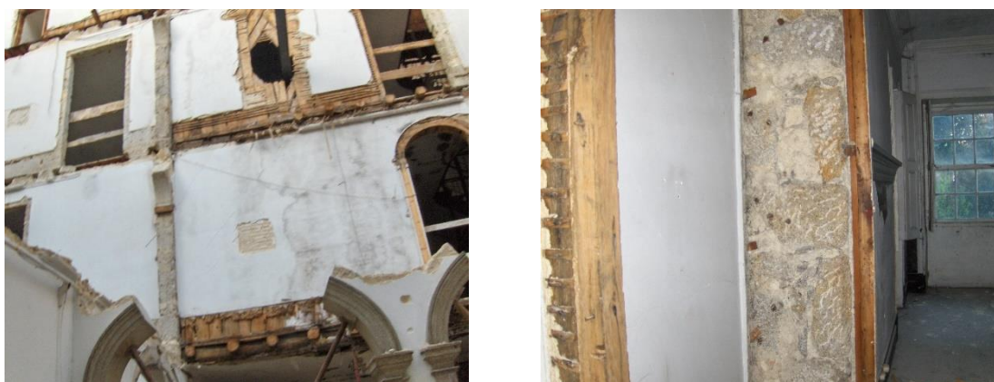
Figura 46 - Paredes interiores em tabique e granito (Fonte: Irmãos Maia, C. C. O. P., Lda.)
