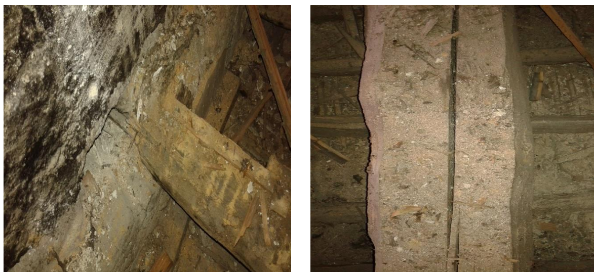
Figura 73 - Ligação de viga de madeira a parede de granito (Fonte: AC Maias Engenharia Lda., 2015)
