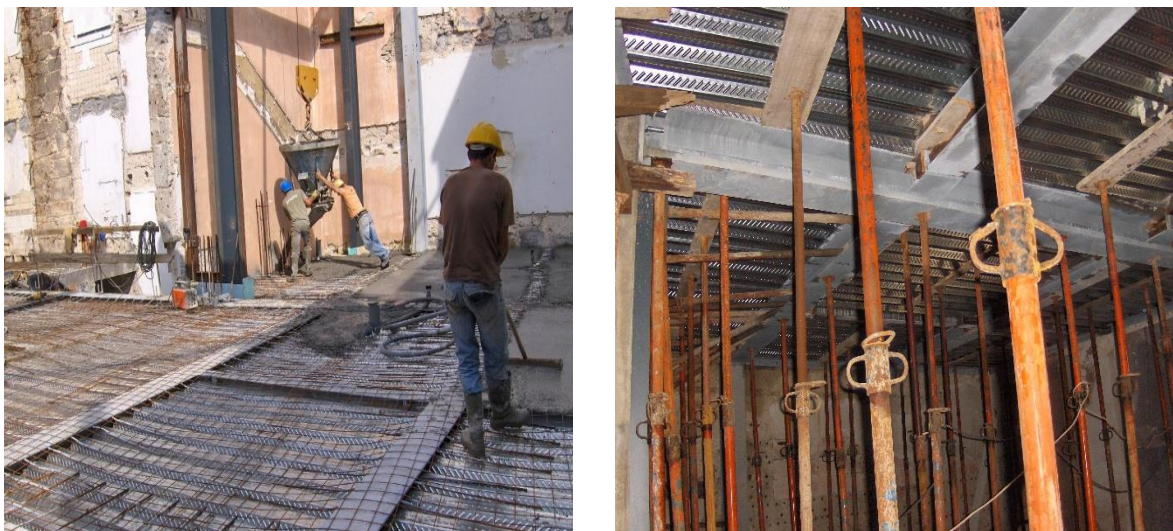
Figura 61 - Betonagem de laje colaborante com respetivo atalochamento manual e escoramento dos pisos (Fonte: Irmãos Maia, C. C. O. P., Lda., 2008)
