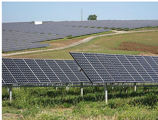
Figura 4 - Central fotovoltaica, Serpa, Beja (Portugal) (Fonte: Panoramio, 2007)
