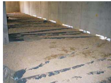
Figura 58 - Tubos em PVC do sistema de arrefecimento do ar pelo solo (ainda em fase de construção) (Fonte: Gonçalves, 2005, p.6)
