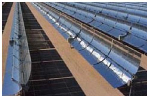
Figura 24 - Fotografia de vários coletores concentradores colocados em série
