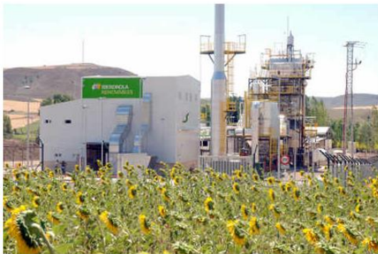
Figura 16 - Central Elétrica de Biomassa de resíduos florestais em Corduente, Guadalajara, Espanha (1)
