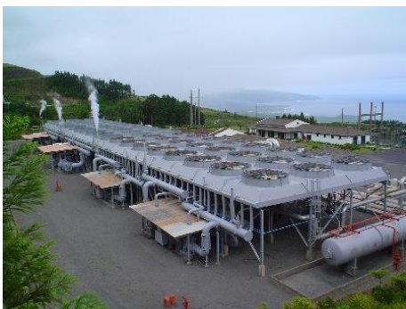
Figura 14 - Central Geotérmica da Ribeira Grande, ilha de São Miguel, Açores, Portugal (1) (Fonte: Câmara Municipal da Ribeira Grande)
