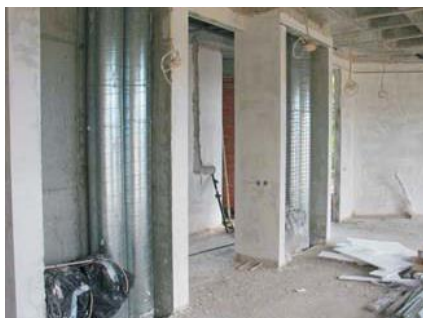
Figura 59 – Colocação das tubagens metálicas do tipo “spiro” nas “courettes” do Edifício Solar XXI (Fonte: Gonçalves, 2005, p.6)
