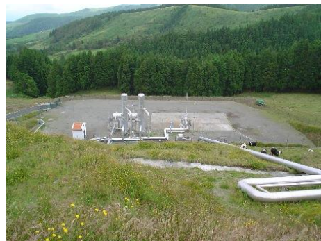
Figura 15 - Central Geotérmica da Ribeira Grande, ilha de São Miguel, Açores, Portugal (2) (Fonte: Câmara Municipal da Ribeira Grande)
