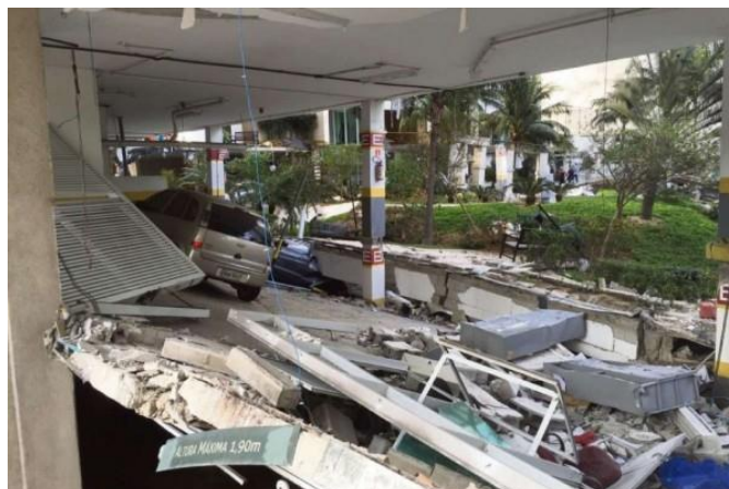
Figura 11 – Acidente estrutural devido ao punçoamento no edifício Gran Parc Residencial Resort
