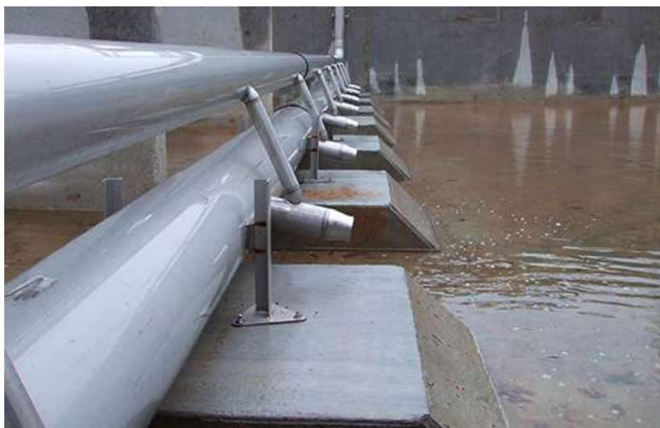
Figura 26- Fotografia de uma instalação JMS (Fluidyne, 2015).
