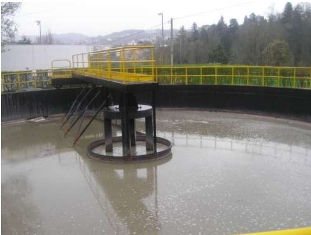
Figura 5- Decantador primário (ETARi, 2010).
