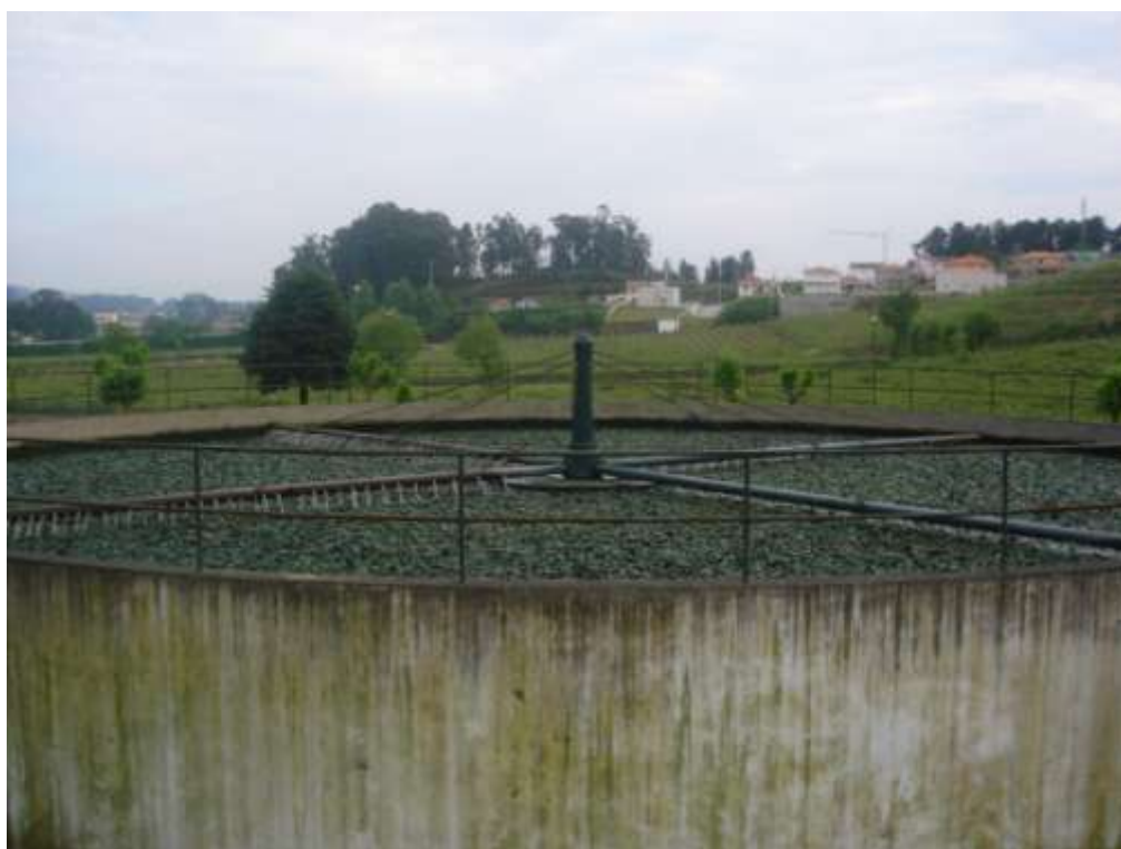
Figura 8- Leito Percolador (ETARi, 2010).
