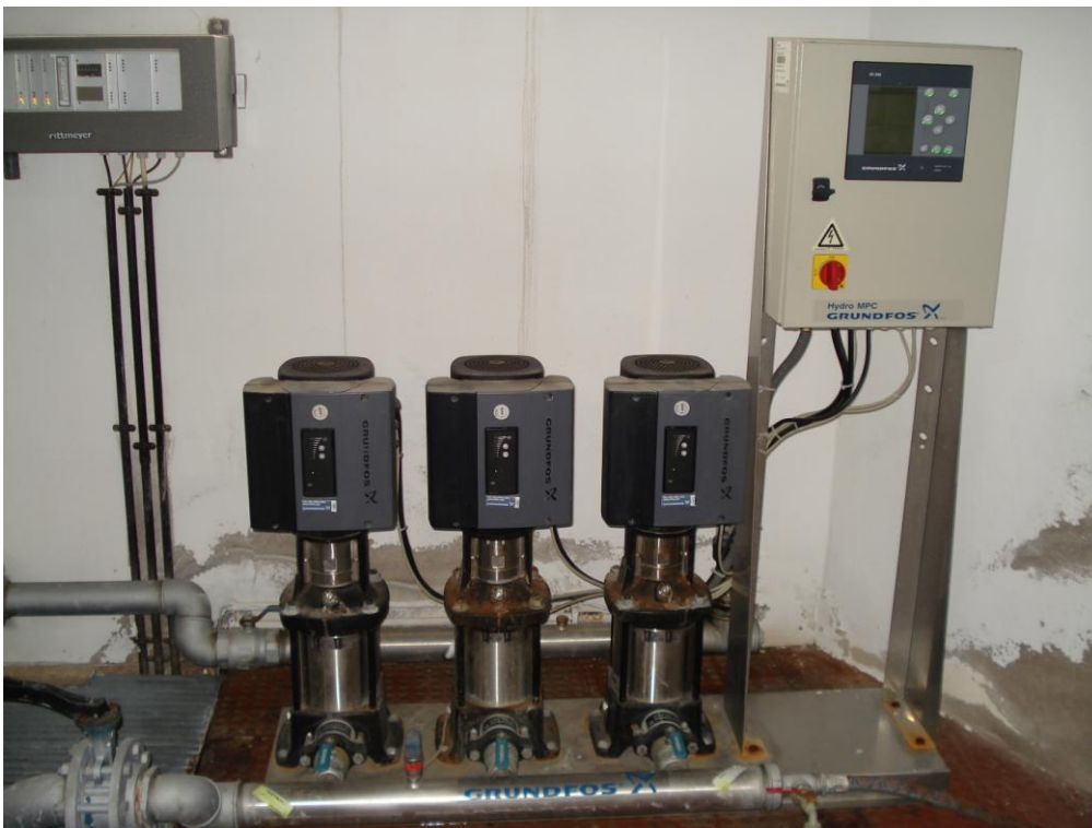
Figura 16: Hidropressores instalados no reservatório (Penafiel Verde, 2012)
