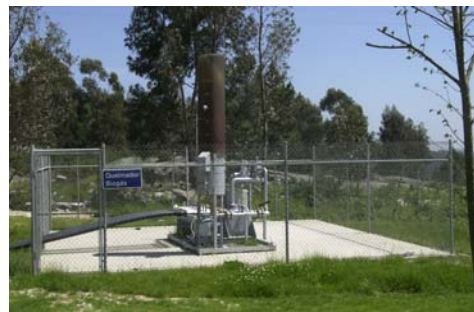
Figura VI.7. - Queimador de biogás do AS de Guimarães.
