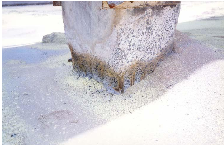
Figura 19. Ataque químico por ácido sulfúrico deteriorou pilar numa indústria de fertilizantes (Aguiar, 2006)
