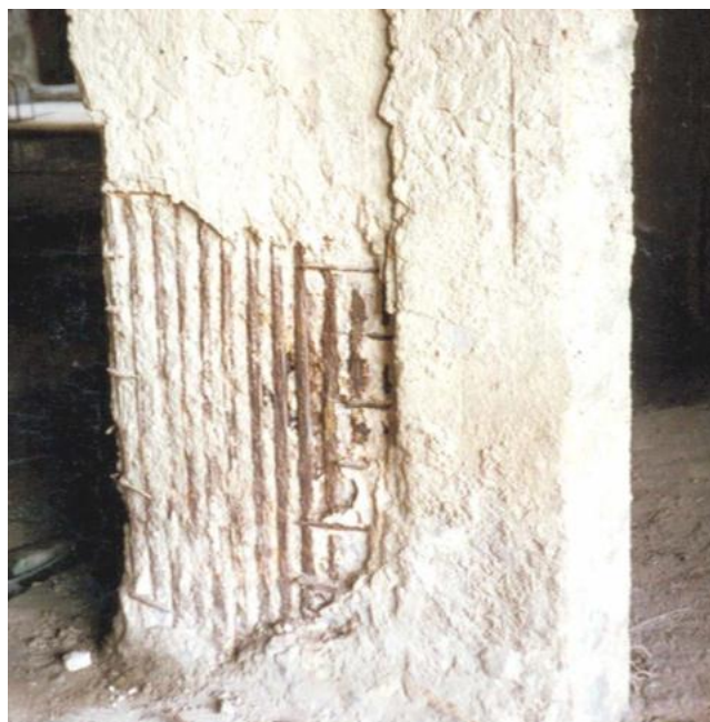
Figura 12. Pilar em indústria com corrosão nas armaduras devido à carbonatação (Aguiar, 2006)
