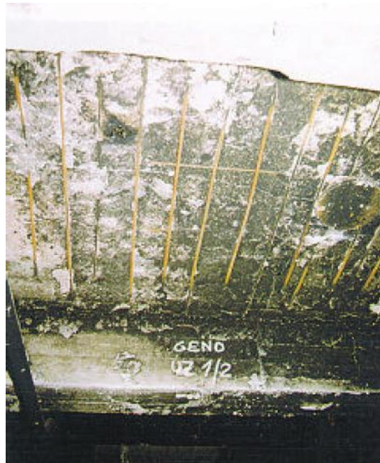
Figura 4. Fotografia do teto da sala do antigo gerador em Turow, após o incêndio, na Polónia em 1999
