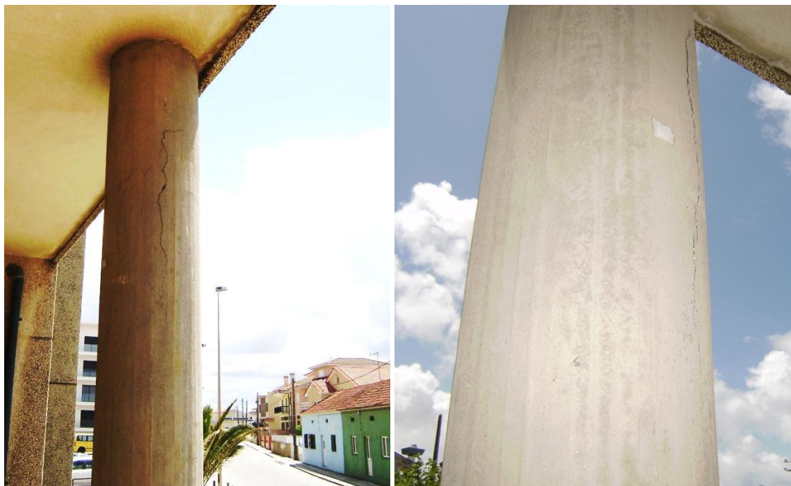
Figura 36. Identificação do problema: pilares de betão armado com grande fissuração e destacamento do betão
