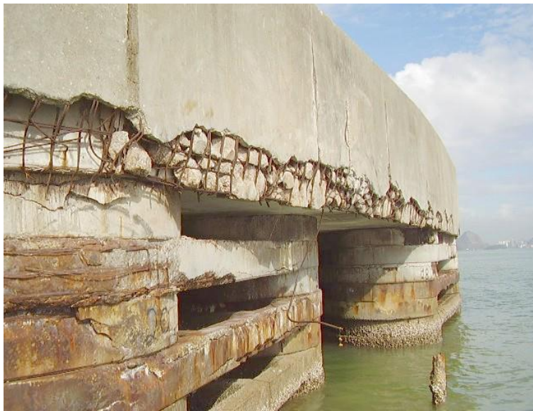
Figura 18. Estruturas de betão localizadas na linha da maré severamente deterioradas (Aguiar, 2006)
