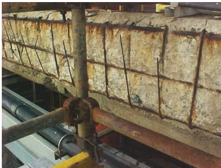
Figura 5. Ataque químico deteriorou severamente uma viga de betão numa indústria química (Andrade, 2003)
