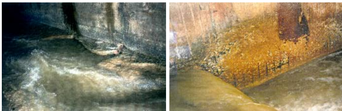
Figura 3. Desgaste em galerias de águas pluviais por: (a) abrasão na laje de fundo e b) erosão, próximo de um degrau (Aguiar, 2000)
