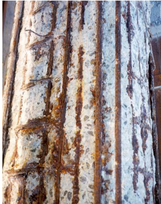
Figura 11. Pilar sobre o mar após 10 anos de construção, deteriorado devido aos efeitos da interação da carbonatação com iões de cloretos (Aguiar, 2006)
