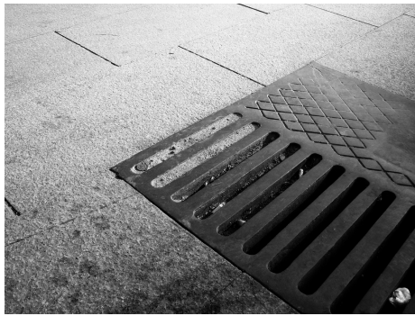
Figura 123 - La única parte visible habitualmente de la infraestructura hidráulica
