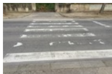
Figura 67, Passadeiras em mau estado. Porto
