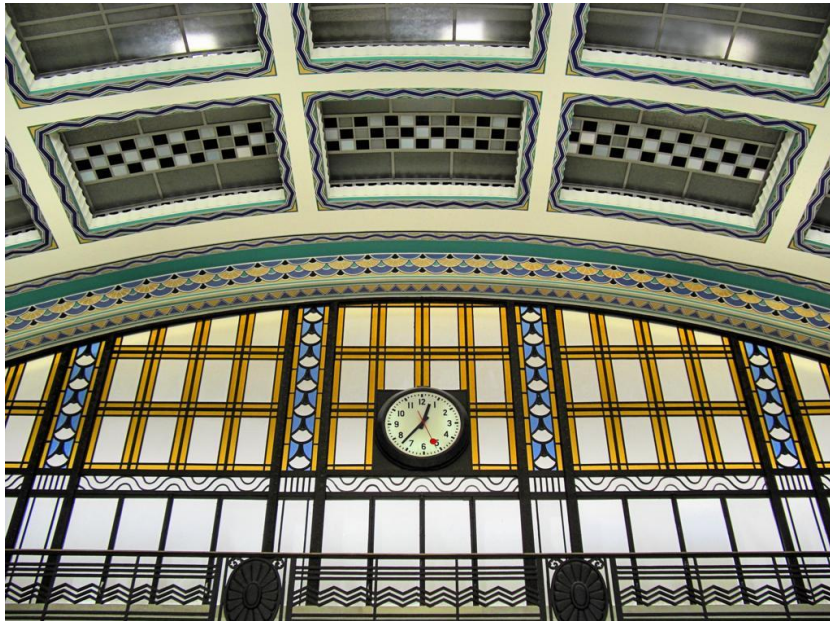
Figura 08 – Vista do Átrio Principal do Cais do Sodré em Lisboa – Pardal Monteiro
