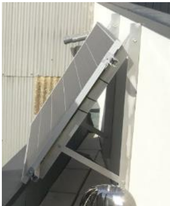
Figura 28: Painel solar fotovoltaico
