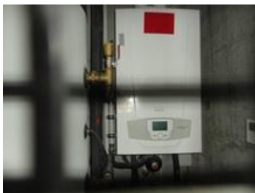
Figura 14: Caldeira a gás propano
