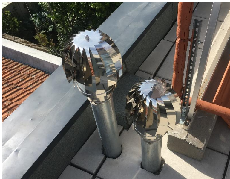
Figura 20: Ventiladores eólicos em aço inox
