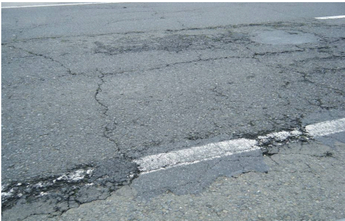
Fendas Transversal e Longitudinal Ramificadas, Desagregação do Pavimento
