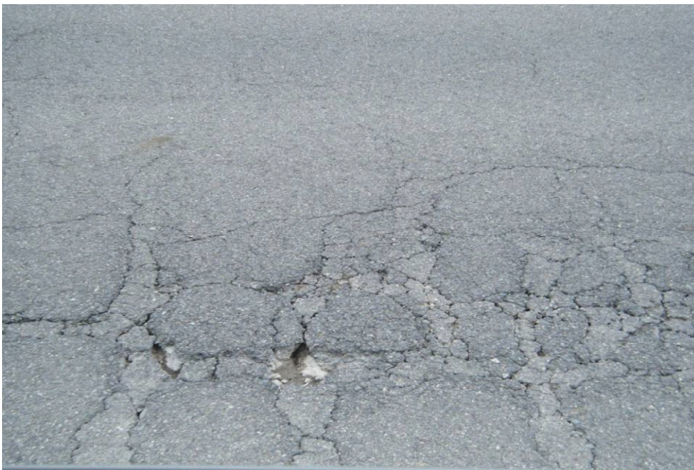
Pele de Crocodilo, Fendas com Bordos Bastante Degradados e Desagregação
