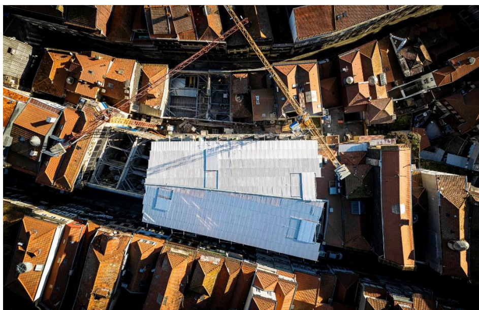
Figura AN.13 Vista aérea do Palácio durante a obra (Fonte: Guilherme Oliveira)
