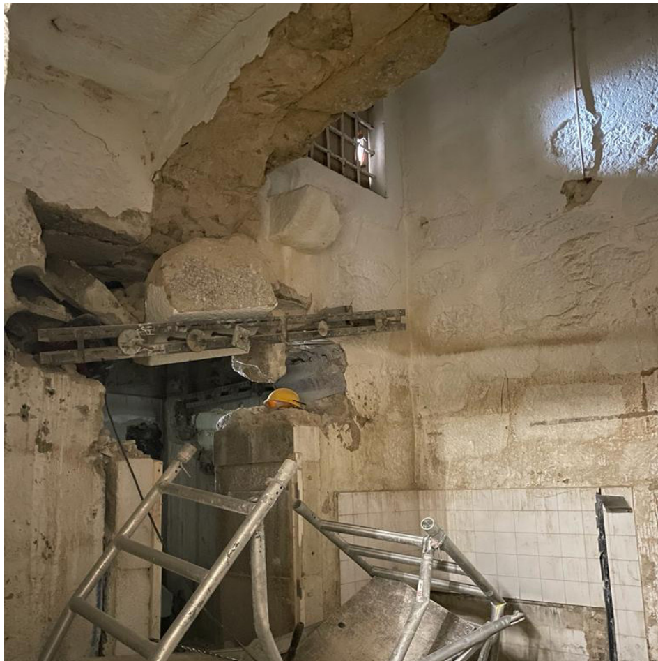
Figura 86 Colapso de arco em pedra
