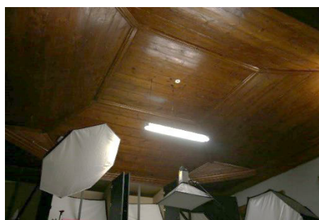
Figura 56 Teto da Sala D
