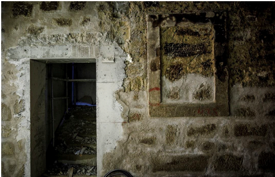
Figura AN.23 Abertura de vão para caixa de escadas (Fonte: Guilherme Oliveira)
