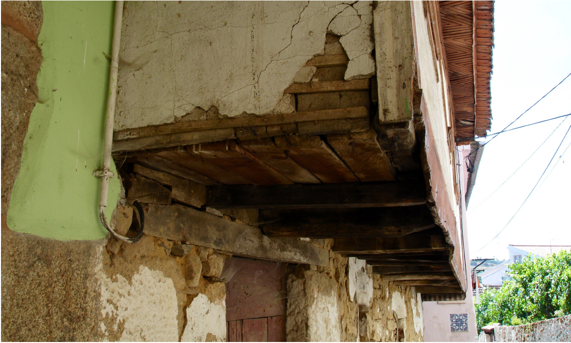
Figura 40 | Fissuração de parede de tabique.
