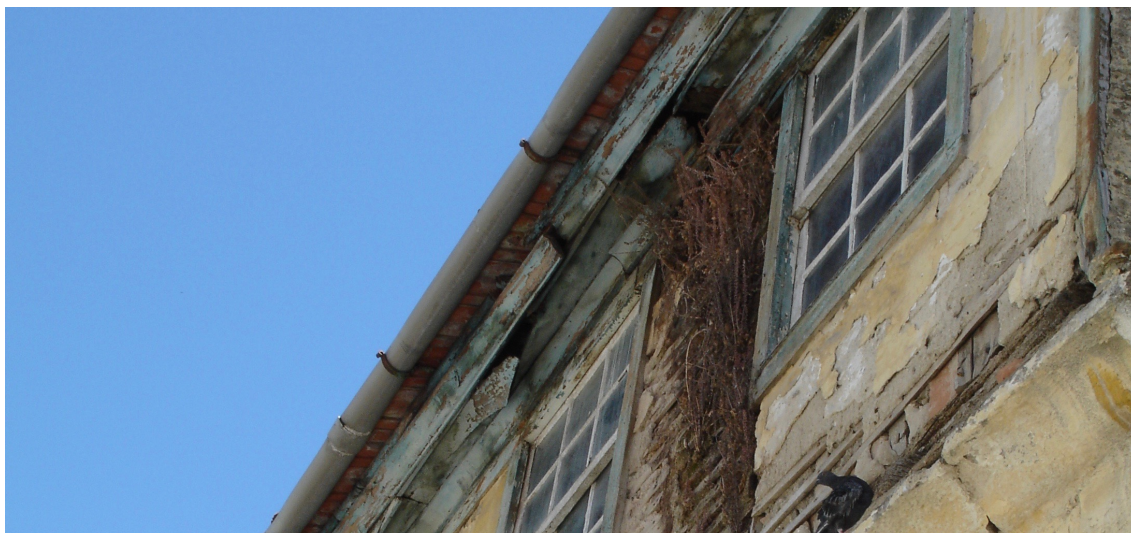
Figura 74 | Presença de raízes nas paredes, Lamego.
