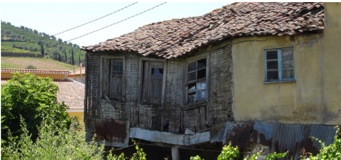
Figura 68 | Edifício colapsado, Peso da Régua.
