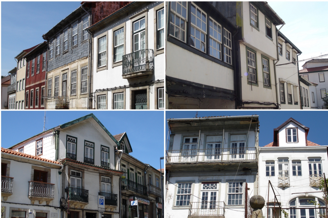
Figura 78 | Presença do tabique nas cidades de Lamego (superior) e Vila Real (inferior).
