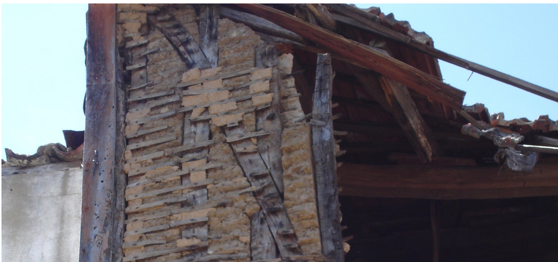
Figura 73 | Ruína de construção em tabique, São João da Pesqueira.
