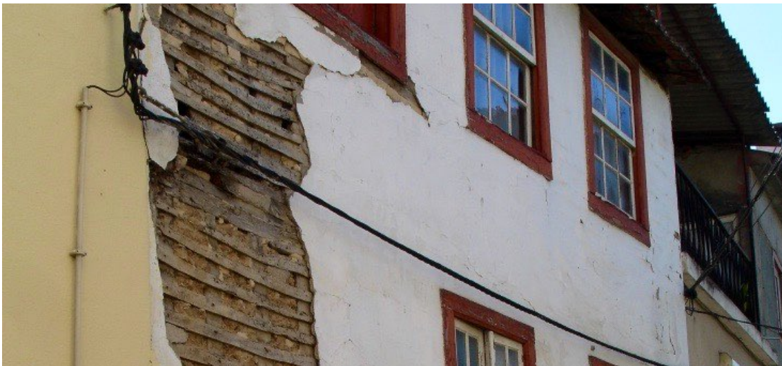
Figura 69 | Destacamento da argamassa, Vila de Salzedas.
