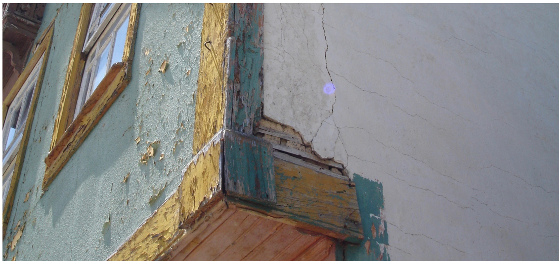
Figura 72 | Parede de tabique degradada por presença de humidade, São João da Pesqueira.
