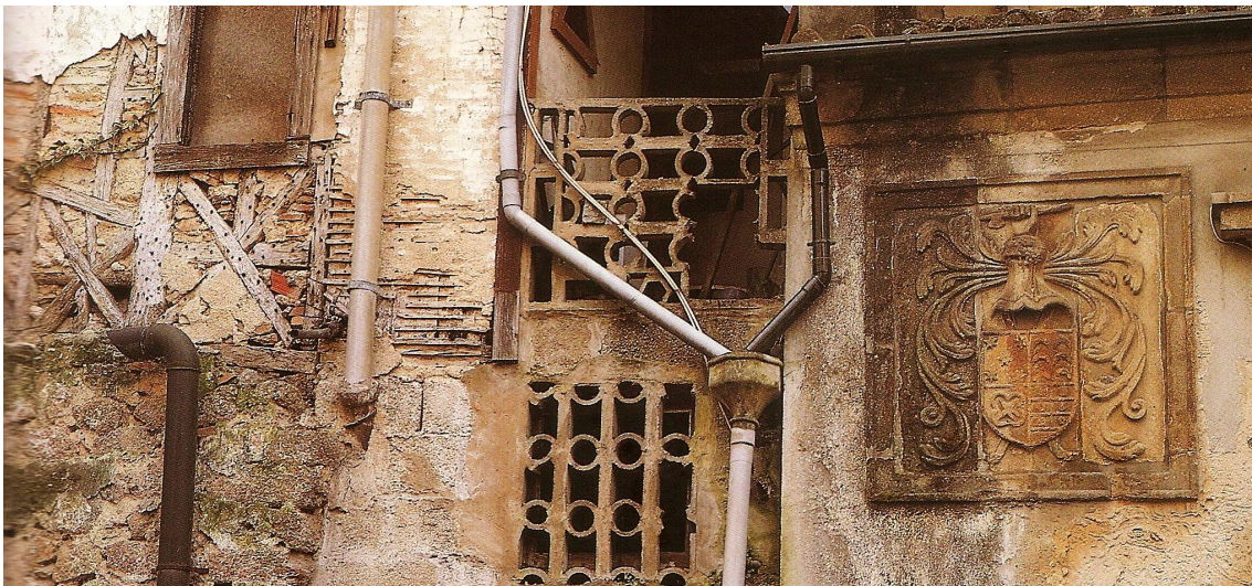
Figura 71 | Processo de degradação através da água.
