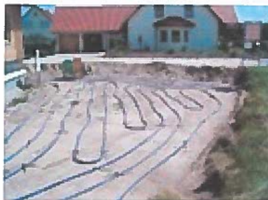
Figura3.2-4 Fotografia de captação Horizontal
