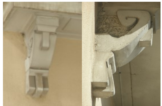
Fig. 31 - Mísulas na Av. Marquês de Pombal nº 2 em Leiria
