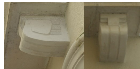
Fig. 33 - Mísulas da Rua da Misericórdia/Trav. da Tipografia em Leiria
