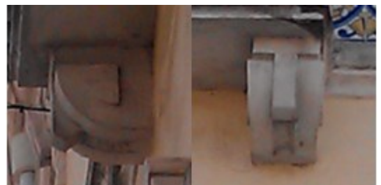
Fig. 32 - Mísulas da Rua Manuel Simões da Maia nº 354 em Leiria
