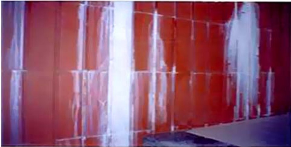
Figura 46 - Aparecimento de eflorescências por fluxo de sais à superfície através das juntas de betumação [4]
