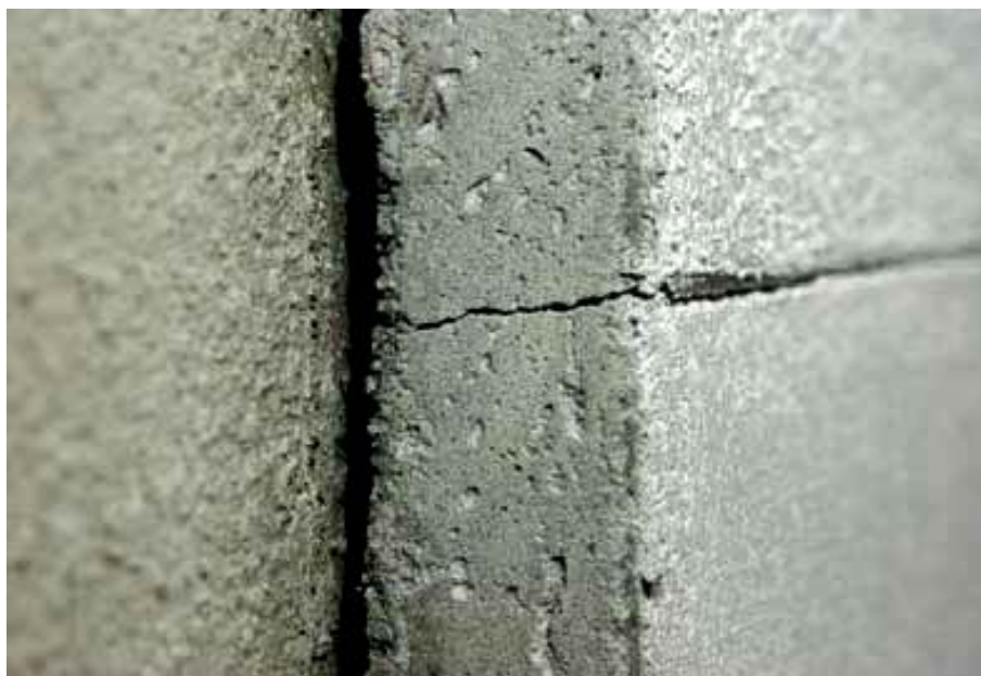
Figura 15 - Fissuração de grande dimensão com deslocamento do bordo do suporte [7]
