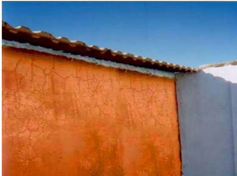
Figura 10 - Reboco de revestimento com aberturas de fendas sem orientação definida e afectando todo o paramento [7]
