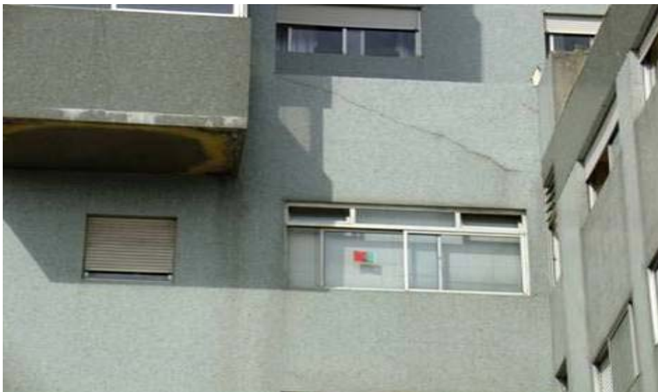
Figura 36 - Fissuração de largura significativa, onde é possível observar que ocorre com orientação definida [7]
