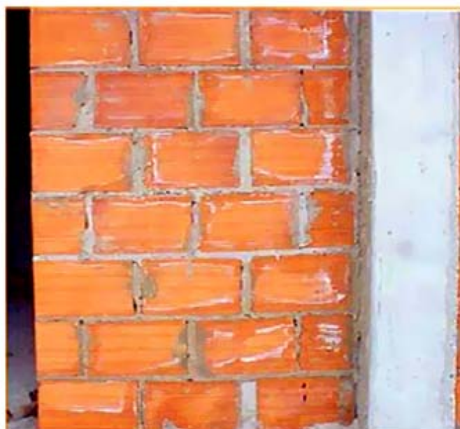
Figura 43 – Exemplo de efflorescência insolúvel [8]
