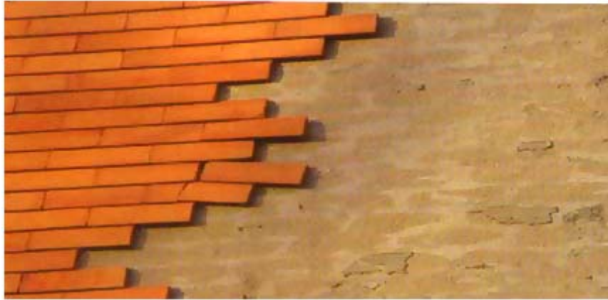
Figura 31 - Queda do revestimento devido a diferentes texturas [1]
