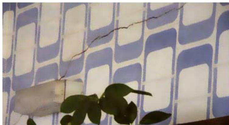
Figura 35 - Fissuração sem orientação definida e distribuída ao longo do paramento de azulejos [1]
