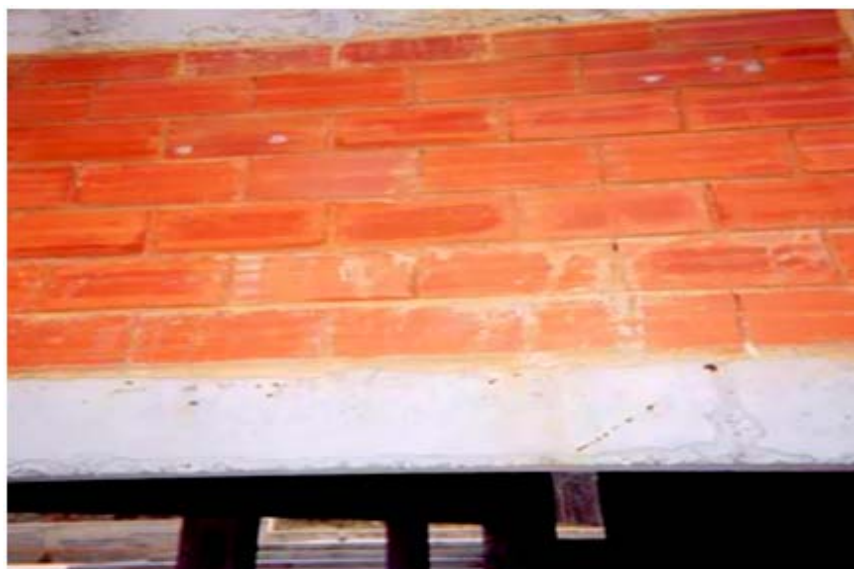
Figura 11 - Fendas com orientação horizontal [7]
