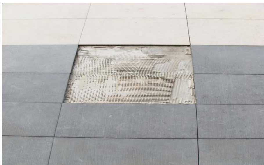
Figura 33 – Deficiente espalhamento de cimento cola na zona de colagem [Arquivo Pessoal]
