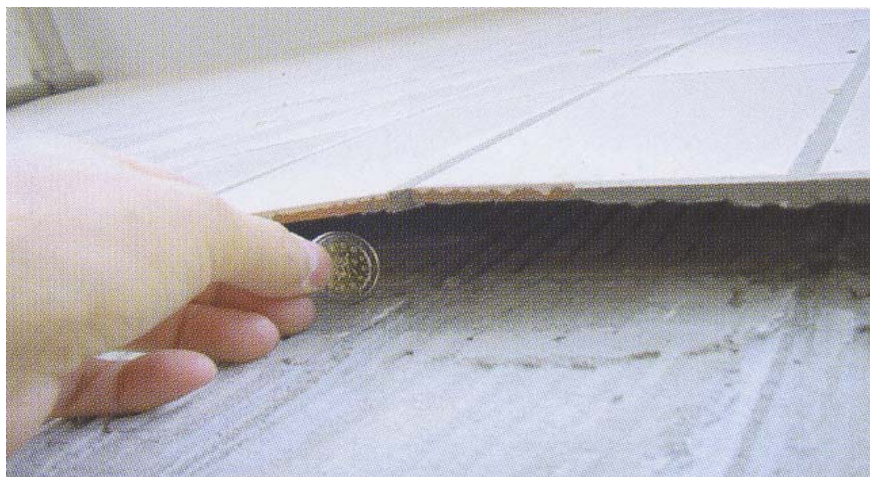
Figura 29 - Descolamento com empolamento grave, indiciando valores de expansão irreversível e juntas demasiado fechadas e/ou realizadas com uma argamassa muito rígida [1]
