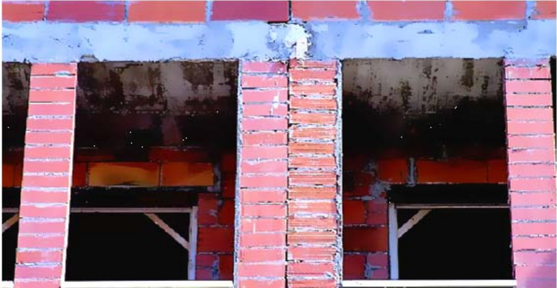
Figura 12 - Fendas de contínuas na junção entre os panos de tijolos e as lajes [7]
