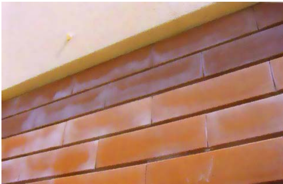
Figura 44 - Eflorescências em parede de embasamento [1]
