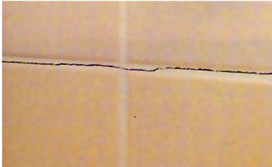
Figura 41 - Fissuração das juntas de argamassa de betumação [1]
