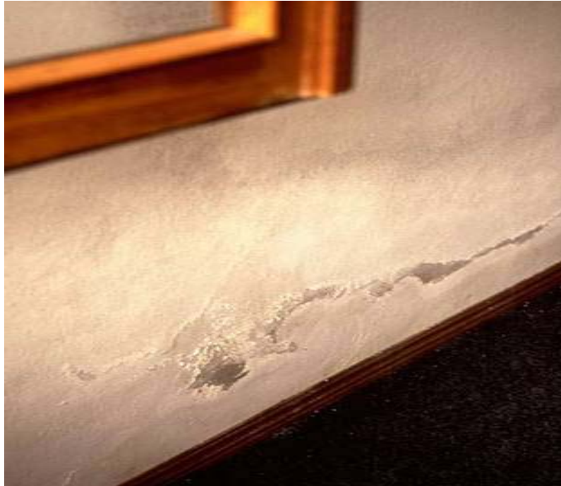
Figura 42 - Efflorescência solúvel numa argamassa de revestimento aplicada numa parede interior [8]
