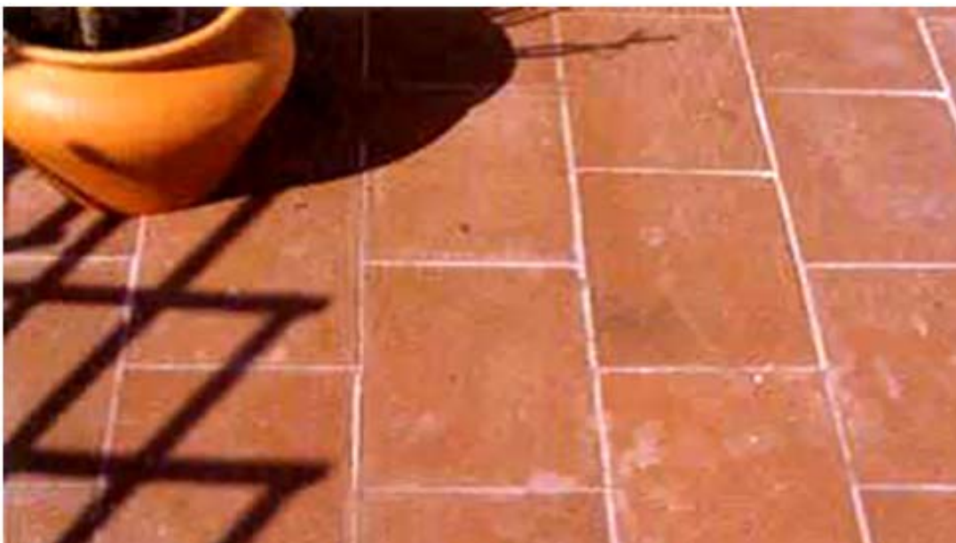
Figura 37 - Manchas em ladrilhos de um pavimento, decorrentes da falta de limpeza e protecção no acto de betumação das juntas [1]
