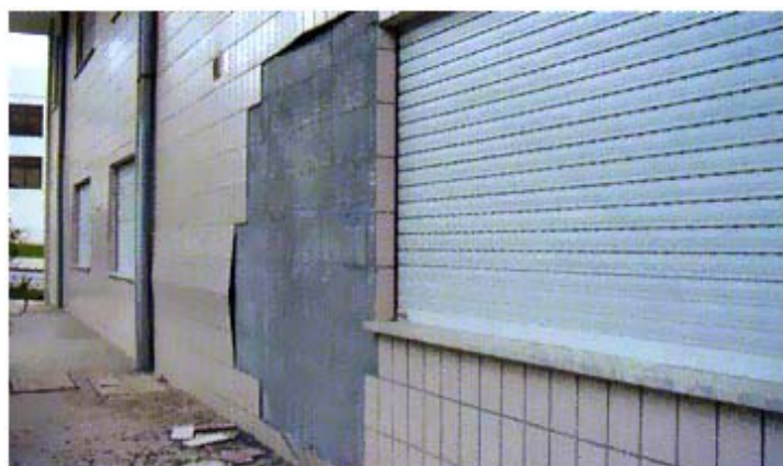
Figura 26 - Desprendimento e empolamento de ladrilhos [1]
