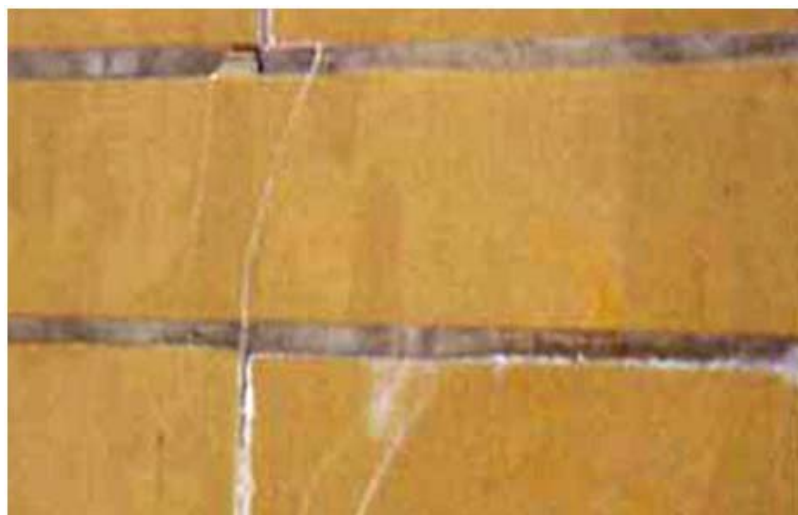
Figura 40 - Micro-fissuração e posterior degradação das juntas [1]
