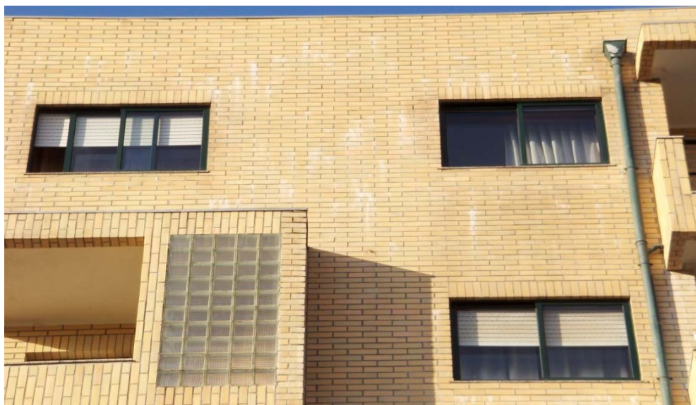
Figura 45 - Fachada onde ocorreu o fenómeno de eflorescência [Arquivo Pessoal]
