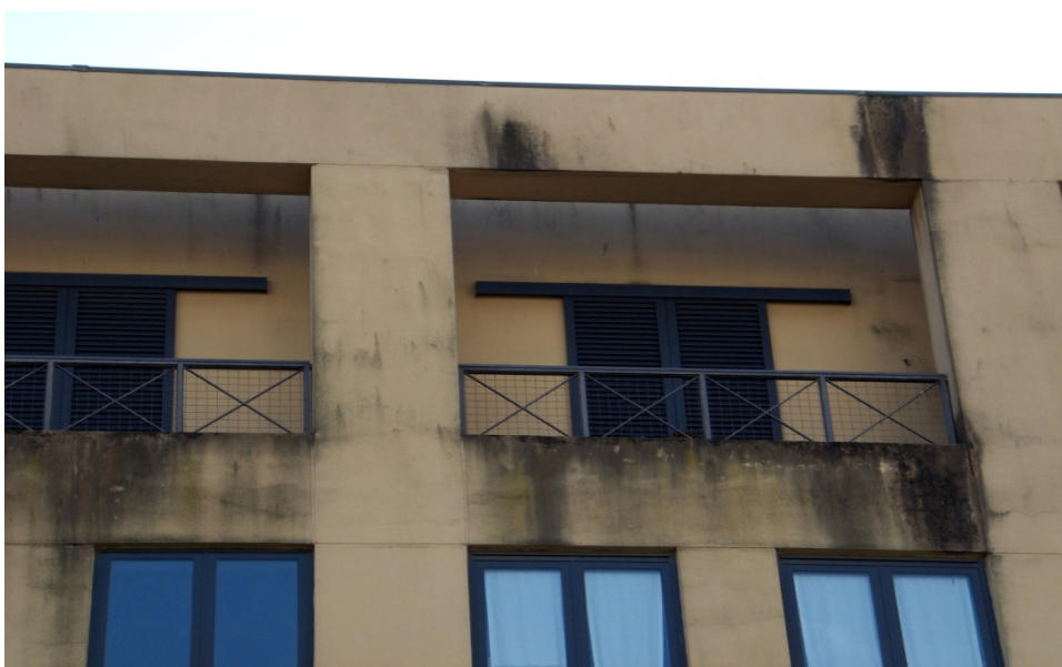
Figura 18 – Manchas de sujidades numa fachada [Arquivo Pessoal]
