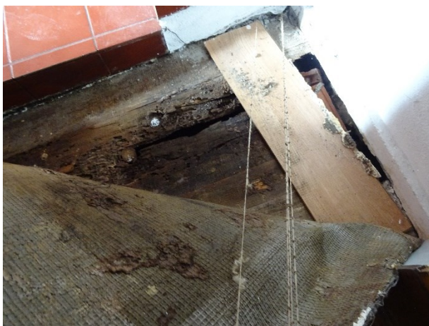
Figura 42: Soalho Degradado Existente
