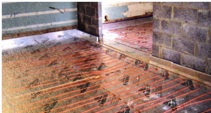
Figura 15: Pavimento Radiante a Água
