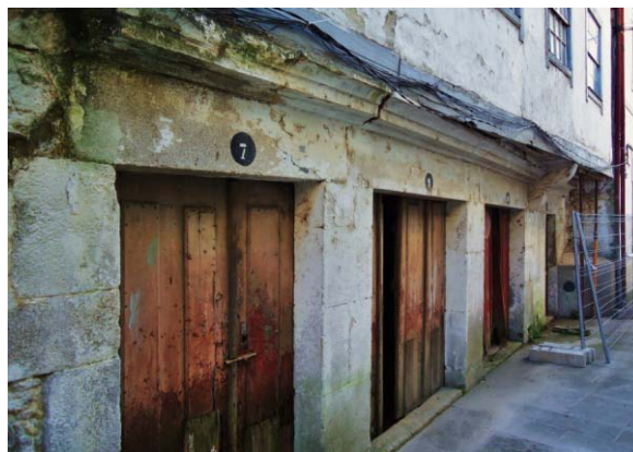
76 – O avanço do corpo dos sobrados (em tabique) sobre o rés-do-chão não é paralelo, evidenciando uma correcção do alinhamento da rua, que foi imposta ao edifício
