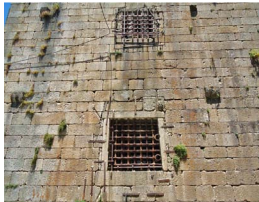
40 – A evidência de pedras sigladas e de distorção da regularidade da silharia, pela ampliação tardia dos vãos, denunciam diversas campanhas de intervenção
