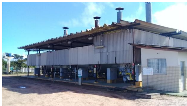
Foto 20 - Caldeiras para aquecer os fluídos dos tanques de lavagem e o petróleo para transferência
