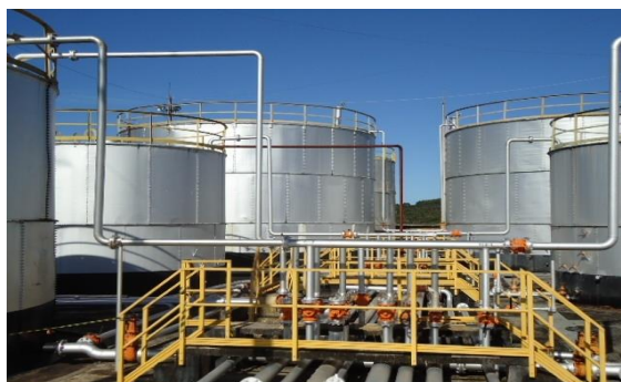
Foto 17 - Tanques de coleta de fluido (petróleo e água) e de teste de produção de poço
