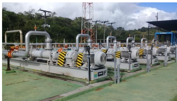
Foto 18 - Bombas BCPH de transferência de petróleo
