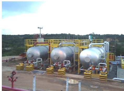
Foto 15 - Vasos separadores horizontais trifásicos
