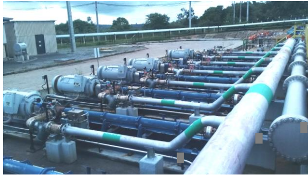
Foto 19 - Bombas BCSH de injeção de água produzida
