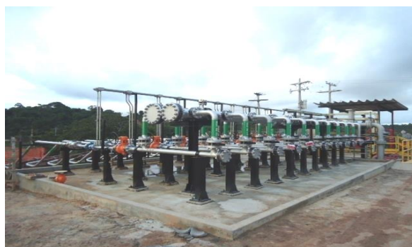
Foto 13 - Manifolds e linhas/dutos de injeção de água produzida
