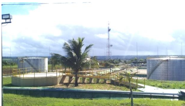
Foto 24 - Tanques de armazenamento de petróleo tratado / especificado
