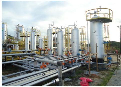
Foto 14 - Vasos separadores verticais bifásicos
