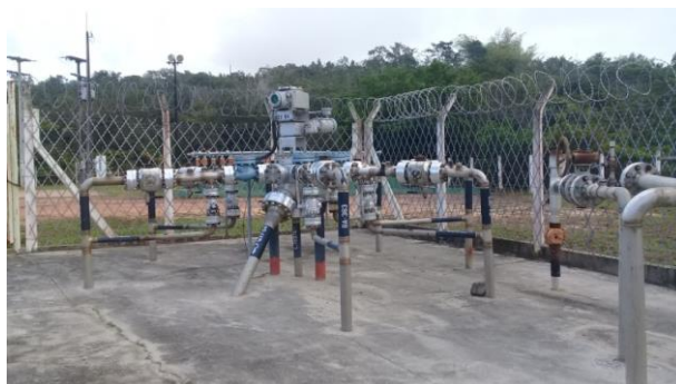
Foto 11 - Multivia e dutos/linhas de produção e de escoamento de petróleo, gás e água produzida ou de injeção de água produzida, gás ou vapor
