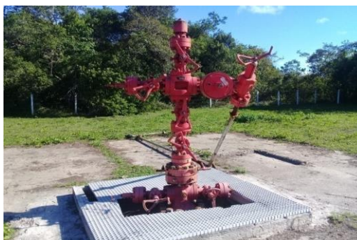
Foto 3 - Poço equipado com o método de elevação natural Surgente (S)
