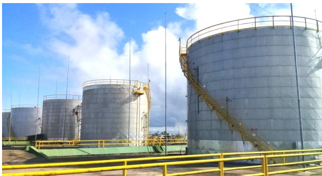
Foto 21 - Tanques de lavagem e tratamento de petróleo
