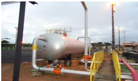
Foto 25 - Vazão separador horizontal bifásico de gás natural e condensado
