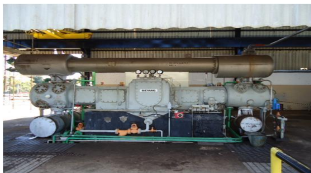
Foto 26 - Compressor alternativo para movimentação, injeção e exportação de gás natural
