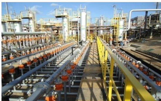
Foto 12 - Manifolds de válvulas e linhas/dutos de escoamento de petróleo
