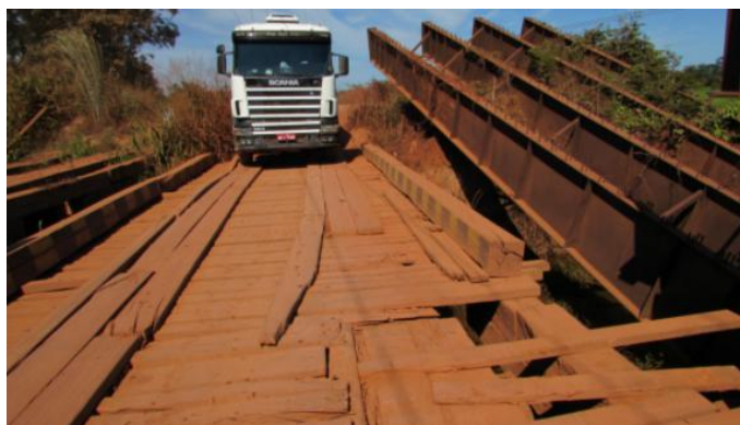
Figura 27 - Exemplo de uma ponte provisória de madeira com deslizante (ou rodeiro) desgastado. (VAZ, Lúcio / Congresso em Foco, 2016).
