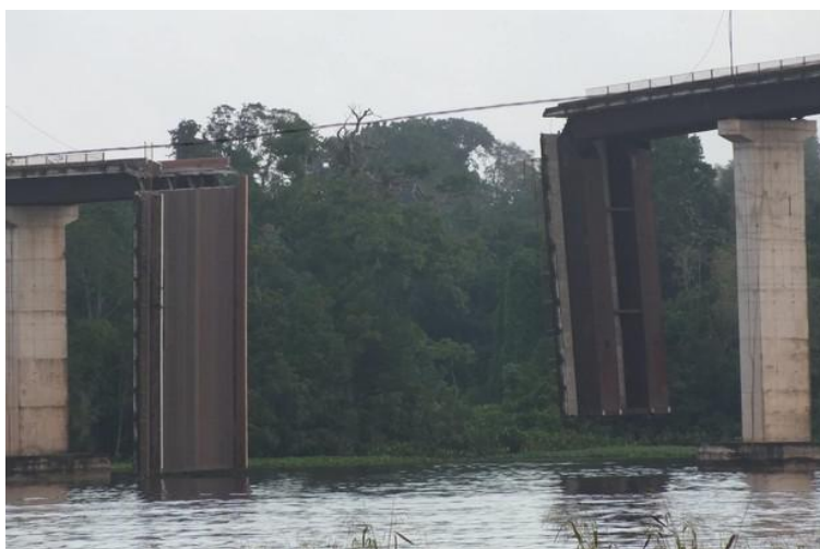
Figura 11 - Colapso da 4ª Ponte da Alça Viária no Rio Moju, estado do Pará, em 23 de março de 2014 (G1-PA, 2014)
