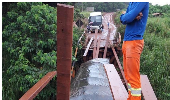
Figura 2 - Colapso de uma ponte de madeira na Rod. Transamazônica, KM 94, em janeiro de 2019 (ADMS, Felype / O Liberal, 2019).
