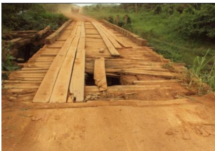
Figura 45 - Ponte 1 (provisória) com deslizantes e pranchetas danificadas, e ausência de guarda corpo e guarda rodas, 2013 (DNIT, 2019).
