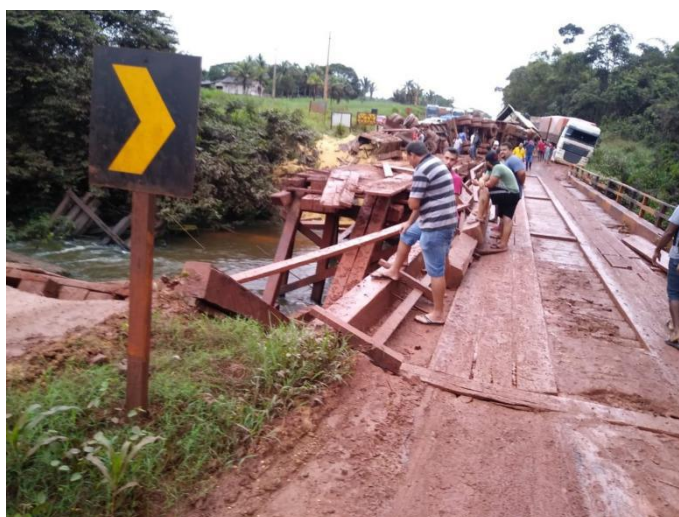
Figura 3 - Ponte quebra e carreta tomba na rodovia BR-230, em 09/02/2019 (G1-PA, 2019a).
