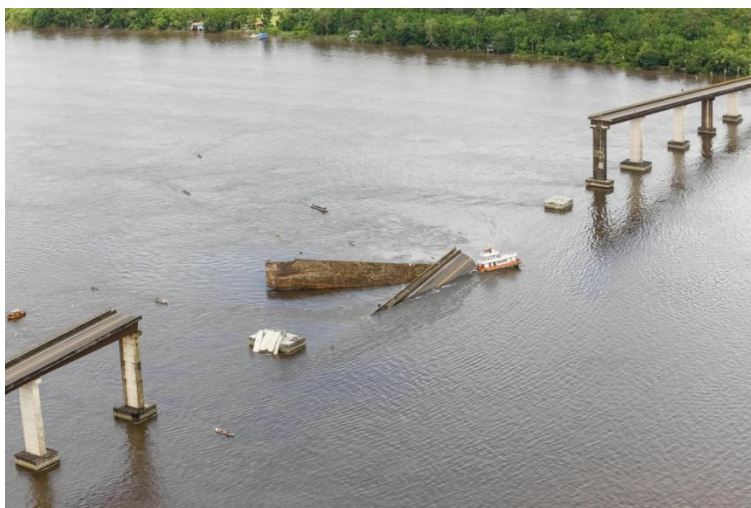
Figura 12 - Colapso da 3ª Ponte da Alça Viária no Rio Moju, estado do Pará, em 06 de abril de 2019 (G1-PA, 2019c).
