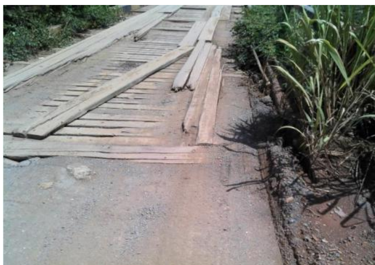
Figura 51 - Ponte 2 (provisória) com deslizantes e pranchetas danificadas, e ausência de guarda corpo e guarda rodas, 2015 (DNIT, 2019).
