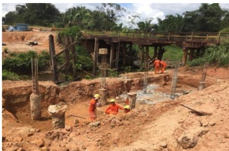
Figura 34 - Execução dos blocos de coroamento da ponte definitiva (Ponte 2), com ponte provisória de madeira ainda em funcionamento (DNIT, 2019).
