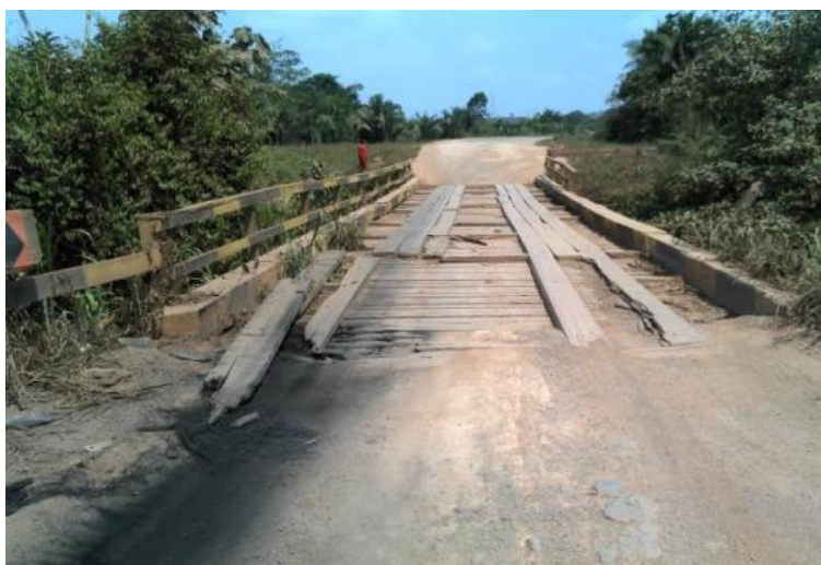
Figura 48 - Ponte 2 (provisória) com deslizantes e pranchetas danificadas, e ausência de guarda corpo em uma lateral, 2015 (DNIT, 2019).
