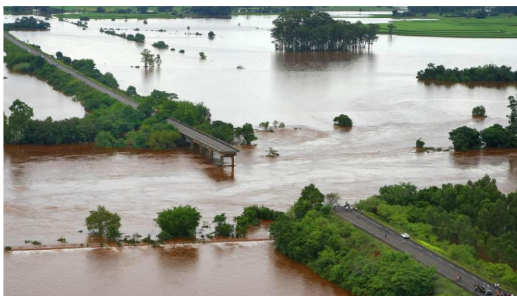
Figura 8 - Colapso da Ponte sobre o rio Jacuí em Agudo-RS, 5 de janeiro de 2010 (Governo do Rio Grande do Sul, 2010)
