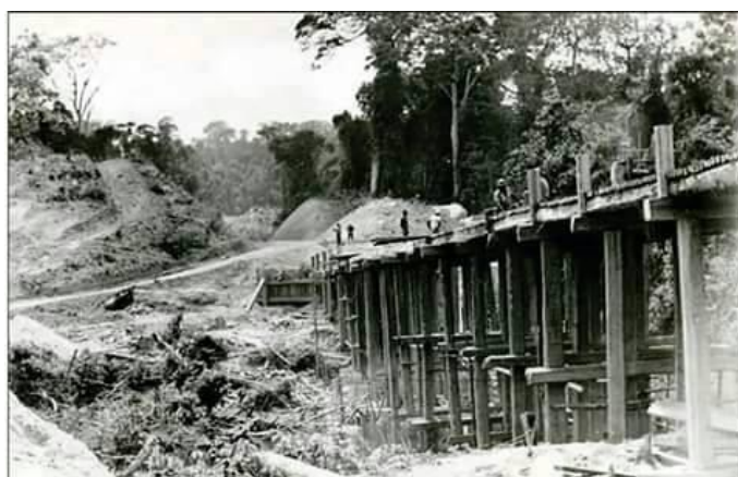
Figura 44 - Ponte provisória de madeira recém construída no ano de 1972 na BR-230 (BRASIL/SIAN - Sistema de Informação do Arquivo Nacional, 2015).
