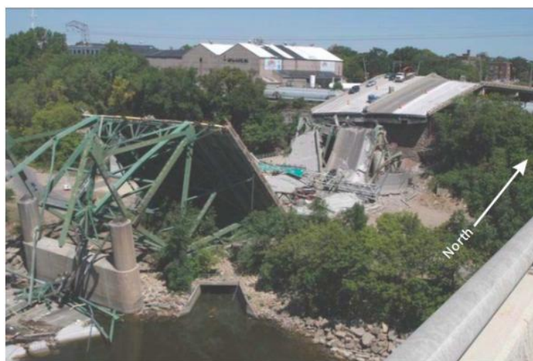
Figura 7 - Colapso da seção norte da Minneapolis I-35W Bridge, Minnesota, USA (NTSB - National Transportation Safety Board, 2008)
