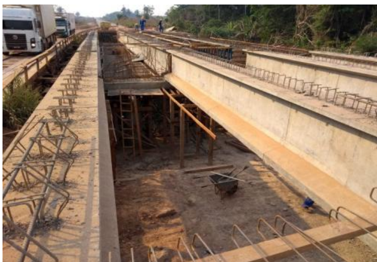
Figura 37 - Retirada de formas das vigas longarinas da ponte definitiva (Ponte 3), com ponte provisória de madeira ainda em funcionamento (DNIT, 2019).
