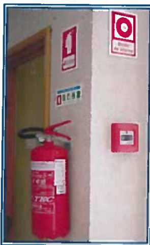
Figura IV.12. – Extintor de pó químico e botoneira de alarme.
