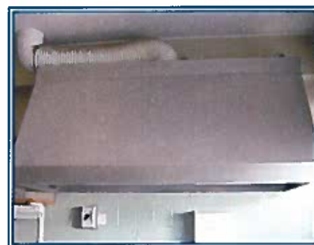
Figura IV.8. – Hotte localizada por cima da banca de despejos de peças.
