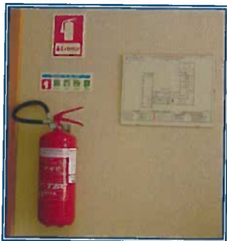
Figura IV.11. – Extintor de pó químico e planta de evacuação.
