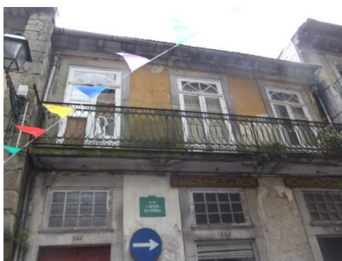
Figura 9 - Ferro na sacada e parede de meação em granito.
