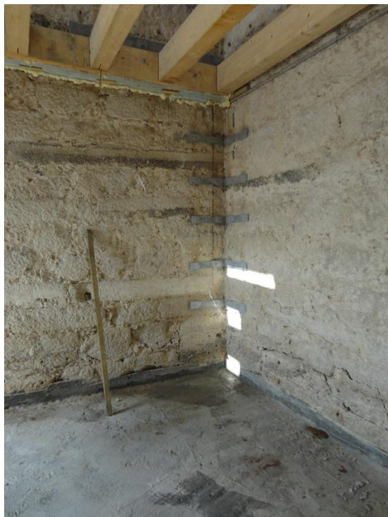
Figura 8 – Paredes com ligantes metálicos (corpo 2).
