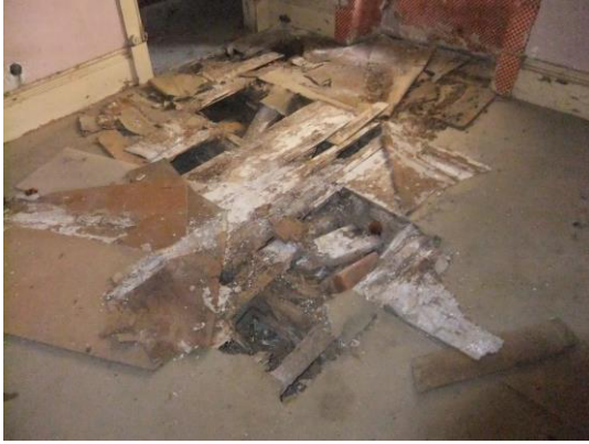
Figura 13 - Pavimentos em mau estado
