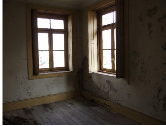
Figura 14 - Fragilidade da estrutura das paredes
