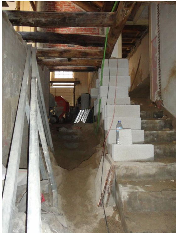
Figura 8 – Zona técnica piso -1.
