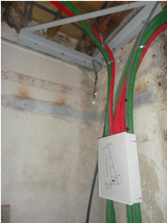
Figura 5 – Quadros e tubos de eletricidade.
