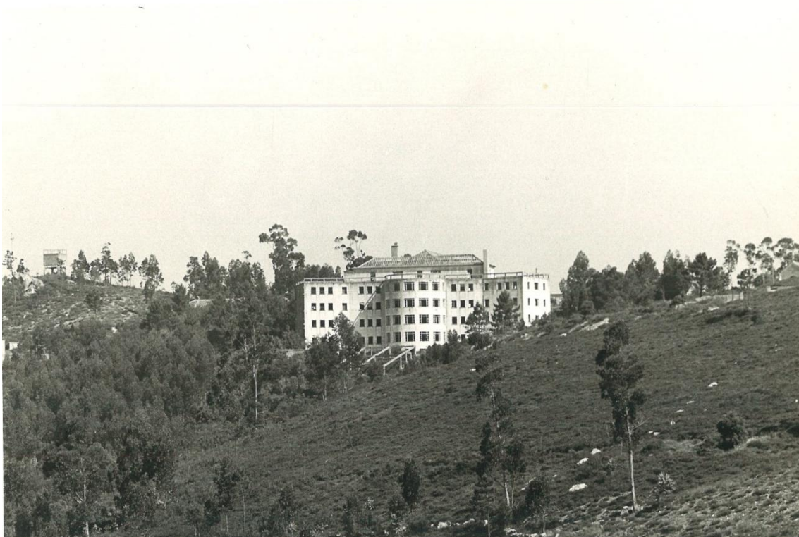
Figura 54 – Sanatório durante a construção (note-se a falta de telhas e visível estrutura da cobertura) Fonte: Arquivo Histórico de Gondomar
