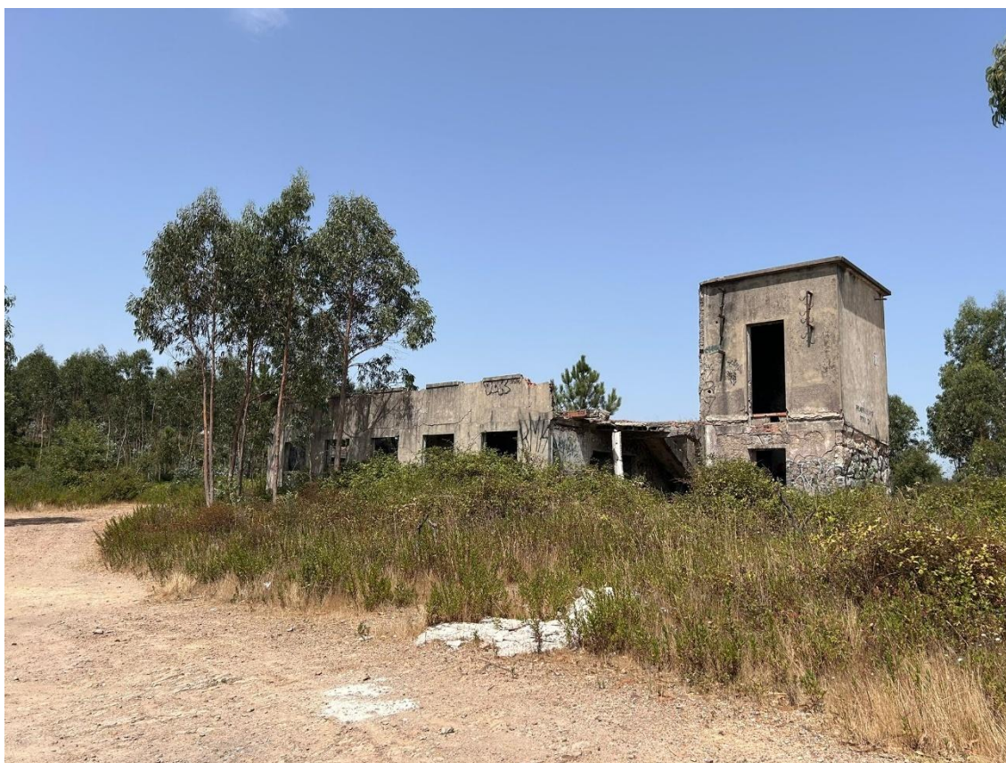
Figura 81 – Ruína do edifício da escola Fonte: Autor, 2025
