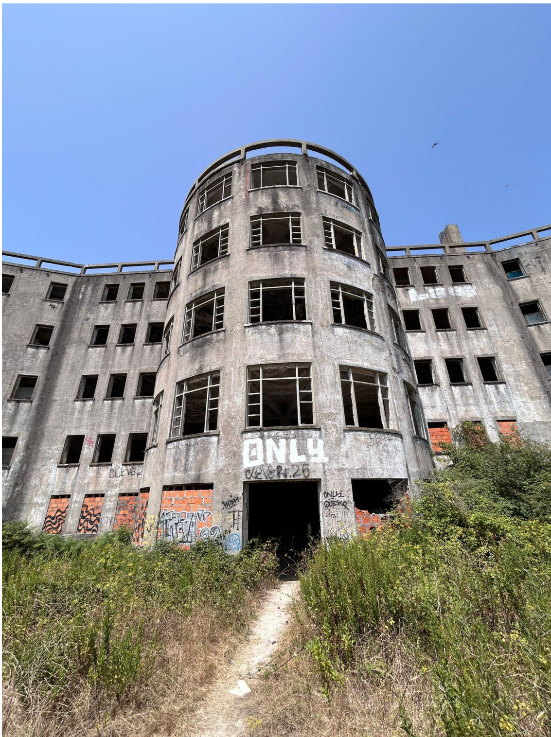
Figura 84 – Fachada Sul (note-se os vãos parcialmente tapados) Fonte: Autor, 2025
