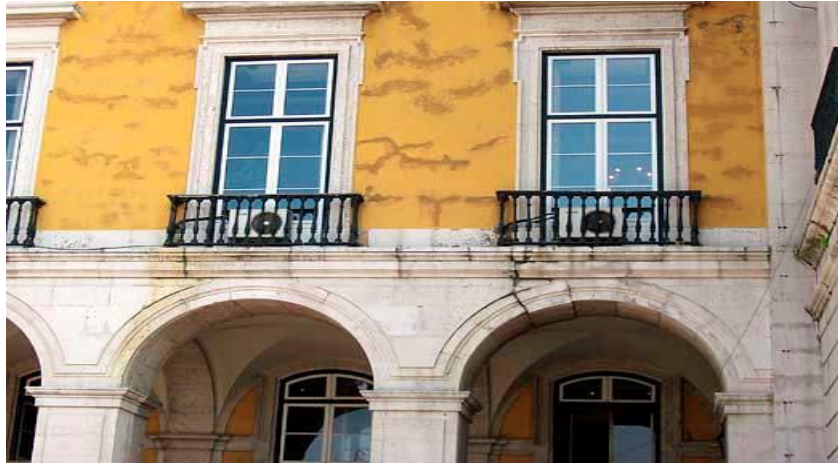
Figura 4 – Patologias na fachada devido a desadequação do sistema aplicado
