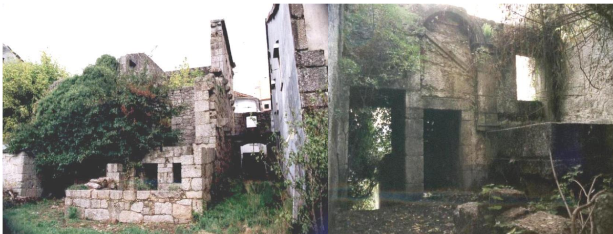
Figura 14 – Ruína da Casa da Portela
