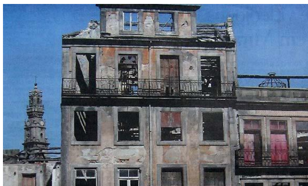
Figura 3 – Edifício com graves problemas estruturais na cobertura e paredes - Porto
