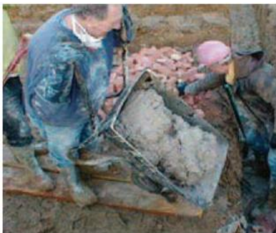
Figura V. 1 – Colocação de tijolos e betão de cânhamo em camadas (Suffolk Housing Society, s.a)
