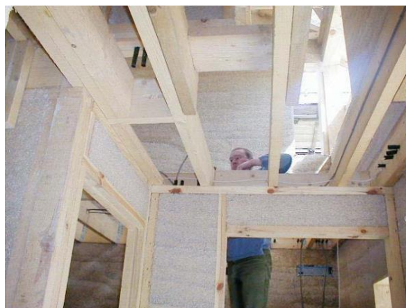
Figura V. 13 – Montagem da estrutura para posterior enchimento das vigotas (Suffolk Housing Society, s.a)
