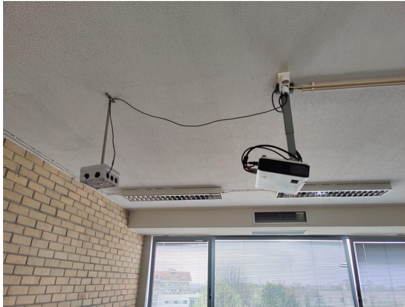
Figura 4.9: Caixa de Monitorização em sala de aula
